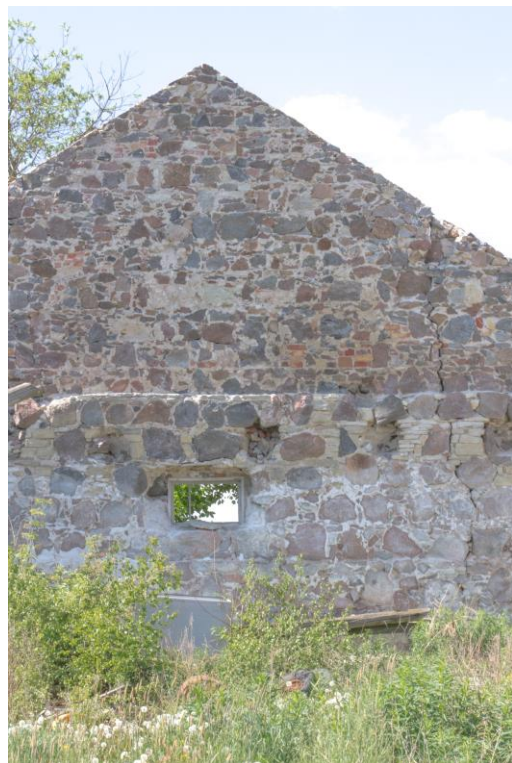
Foto 10. Otsaseina sisevaade ja pragu
