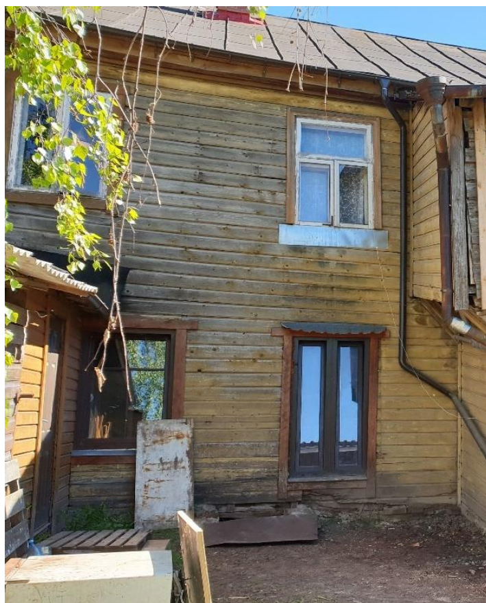
Joonis 6.4 Läänepoolsel küljel kahjustunud alumine palk (autori foto)
