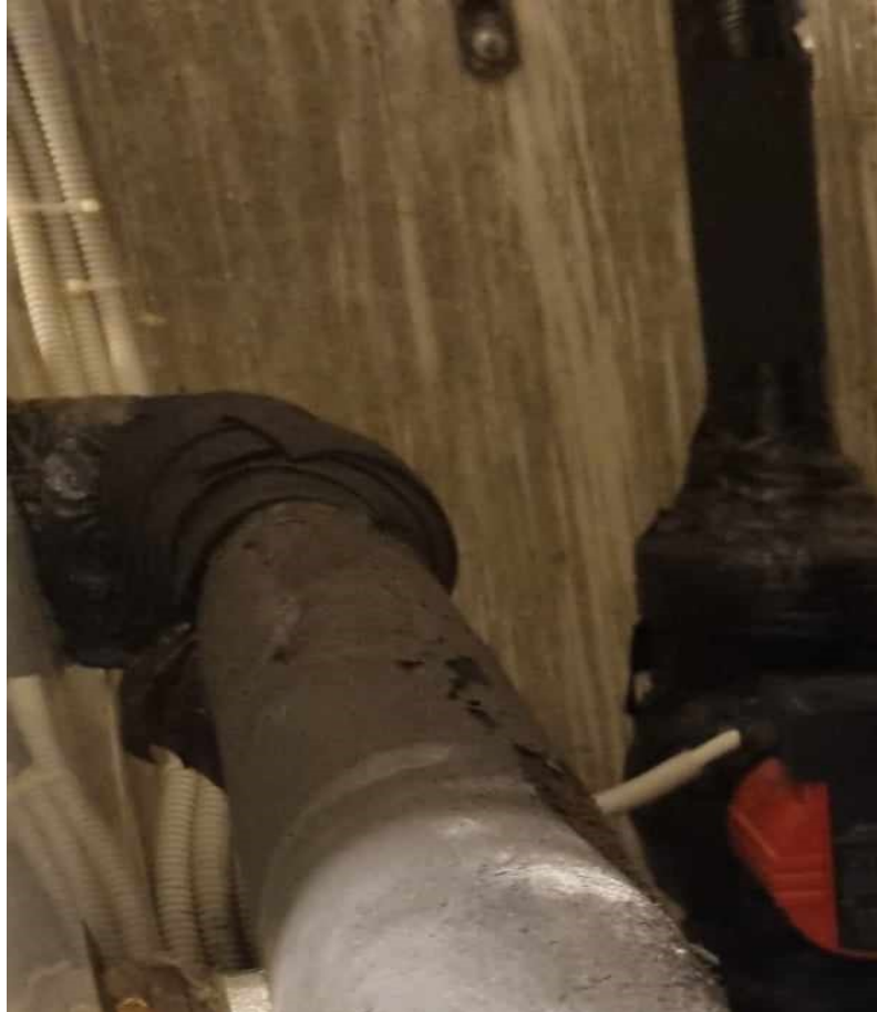
Foto 5.15 Puudub ligipääs küttesüsteemi pumpadele
