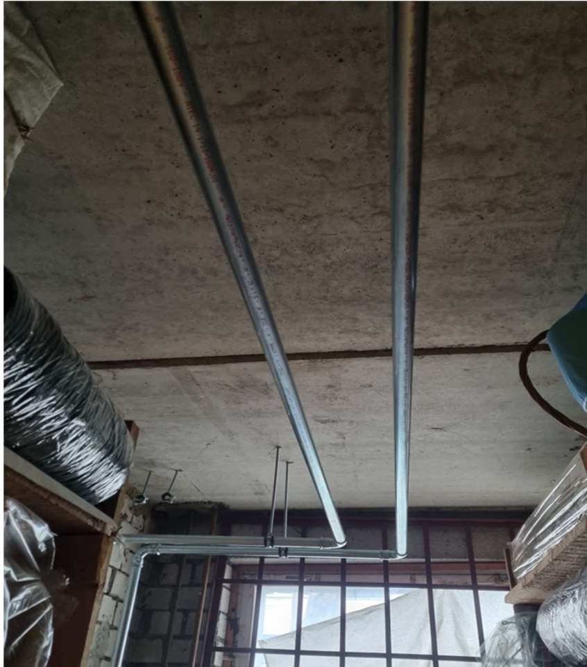
Foto 5.14 Ebakorrektselt paigaldatud küttetorustiku kinnitused
