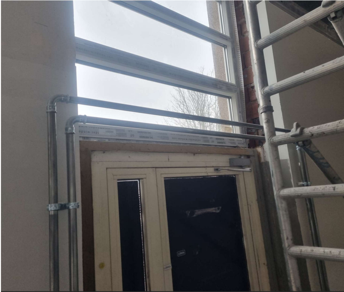
Foto 5.8 Õhueraldusventiilita paigaldatud kütetorustik
