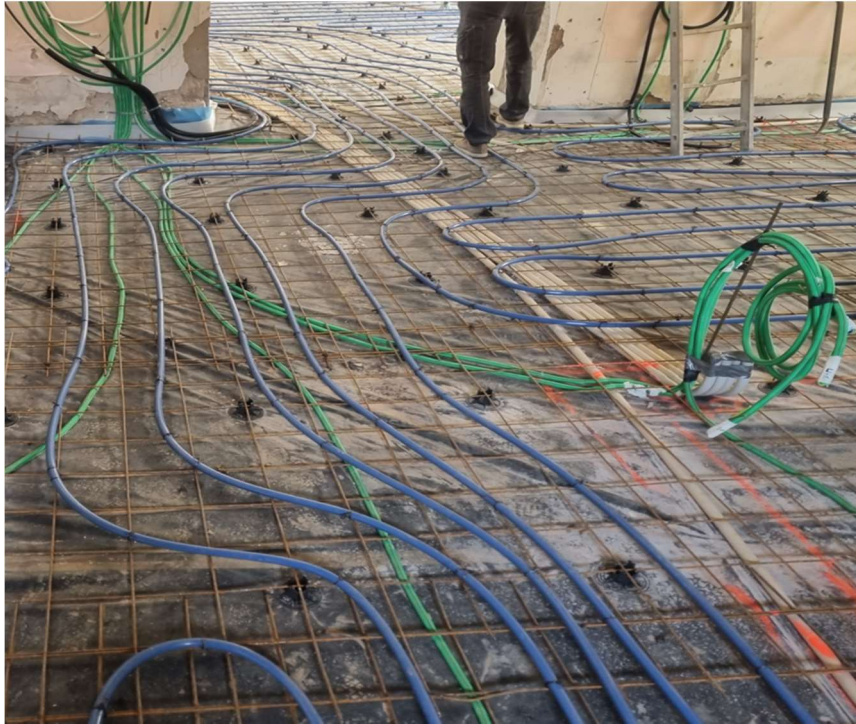
Foto 5.4 Paigaldusjuhendile mittevastavalt paigaldatud põrandakütte torustik
