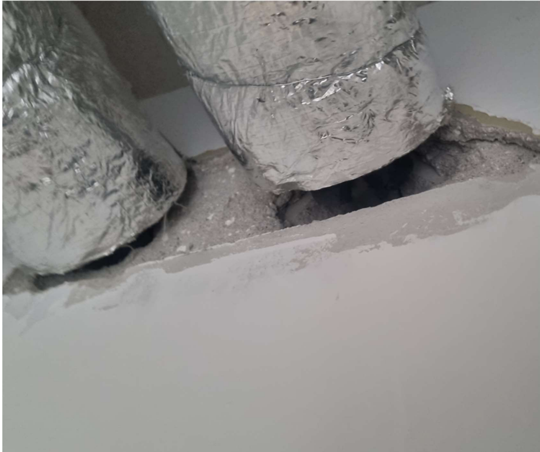
Foto 5.10 Ebakorrektselt teostatud tuletõkke läbiviik
