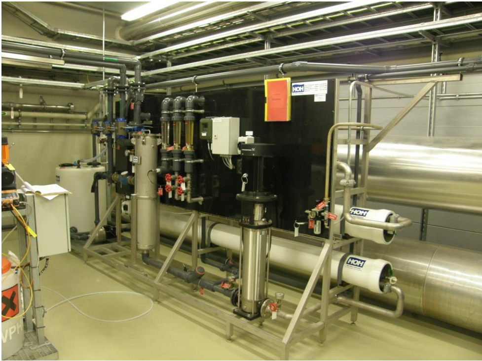
Joonis 17.8. Spiraalsete moodulitega pöördosmoosiseadmed HOH Vao Elektriijaamas
