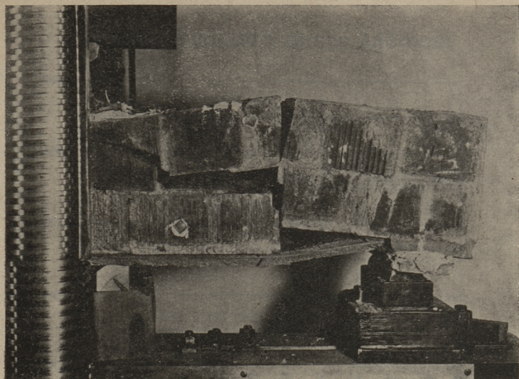
Joon. 15. Talade IT ja IIT purunemise kuju vuugis kivide- vahelise nihketugevuse ületamise tõttu.
