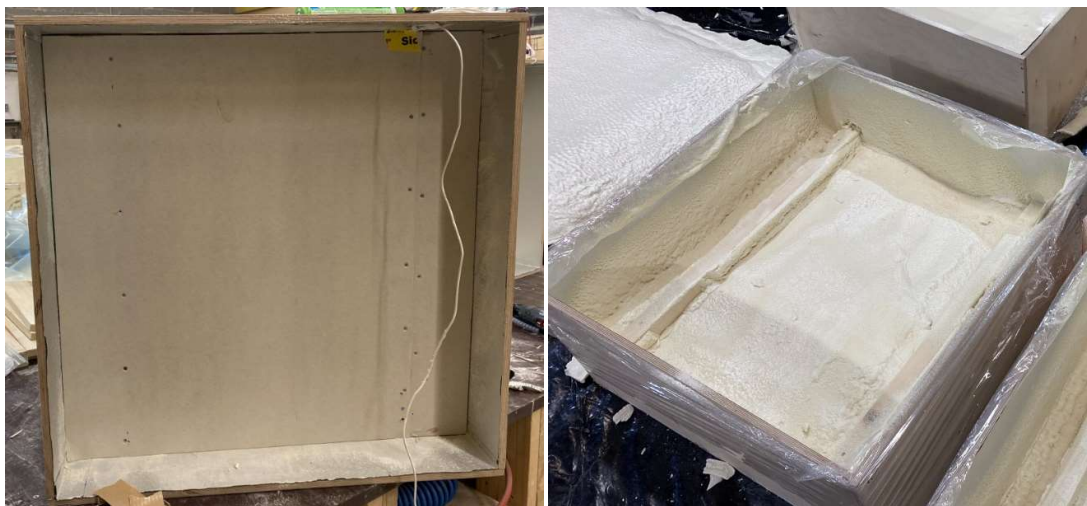
Joonis 3.32 Vasakpoolisel pildil näha vahed kipsplaadi servades ja parempoolisel ebaühtlane PUR vahu kiht sisemise roovi juures
