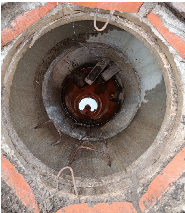
Joonis 5.8. Drenaažikaev hoone lähedal. Allikas: Inseneribüroo REIB OÜ.
