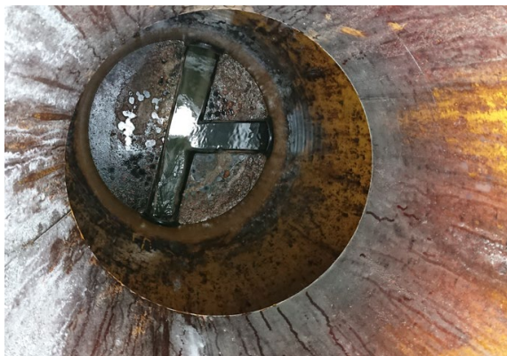
Joonis 5.14. Sademeveekanaliseerimise kaev. Allikas: Inseneribüroo REIB OÜ fotokogu.
