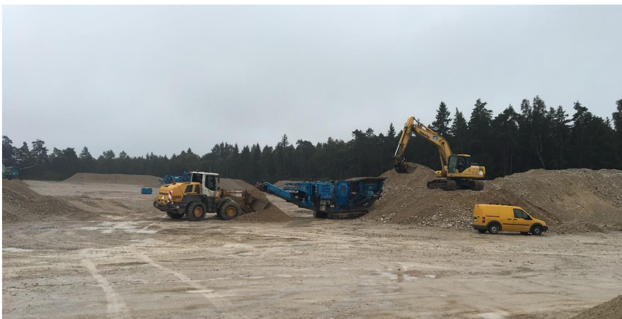
Joonis 54. Ekskavaator Komatsu PC210, lõugpurusti Terex Metrotrak 900x600 ja kopplaadur Liebherr 550. Foto: Erakogu, 17.08.2016 kell 11.42
