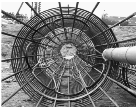
Joonis 11 Soojusjuhtivustorud ühendatuna armatuuri külge [5]
