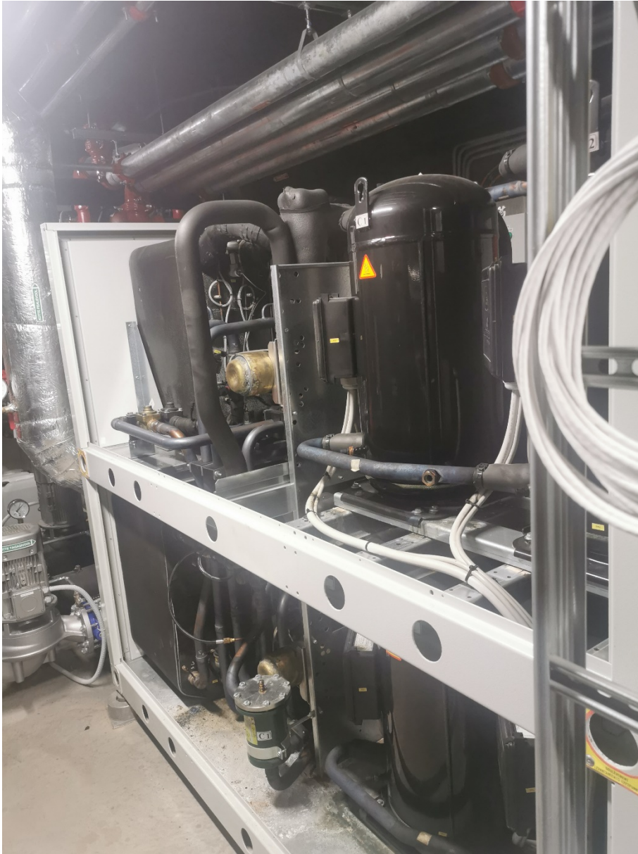
Joonis 26 Woho- 2 hoone sojussõlme külmamasin [23]
