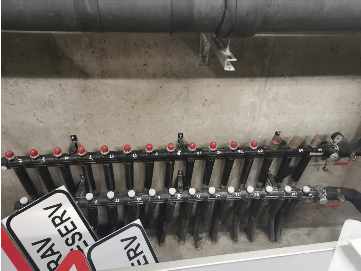
Joonis 31 Woho-2 hoone soojasõlme kollektorkapp [23]
