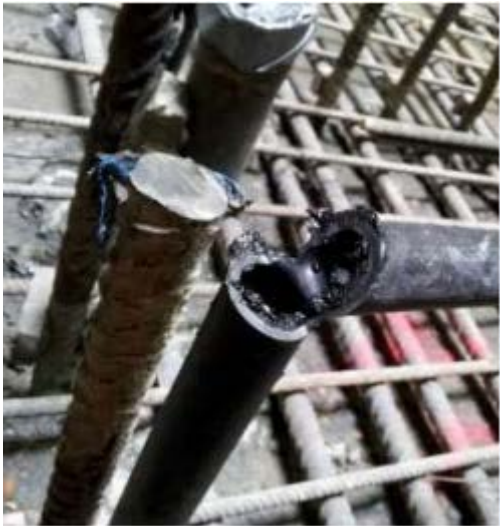
Joonis 18 Murdnunud soojusvahetustoru [16]
