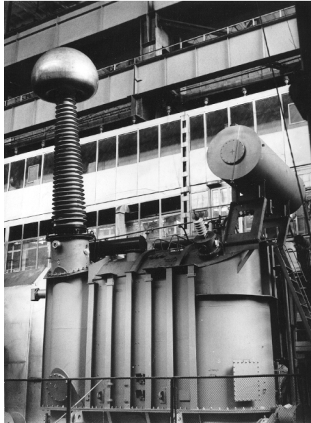
Maailma esimene võimas 3 \times 60 \text{ MV} \cdot \text{A} ja 525 kV juhitav reaktor Zaporozhje katsehallis 1992. aastal.
