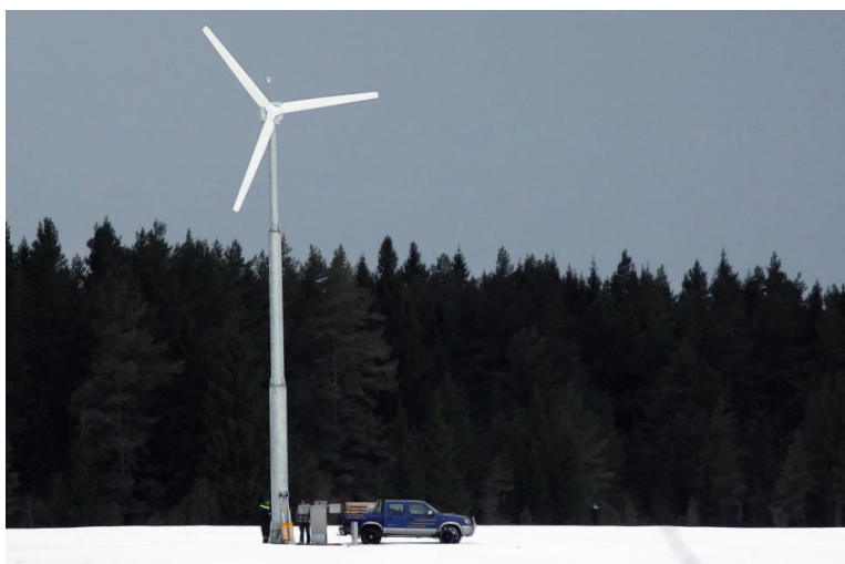
Joonis 5.3.1 Horisontaalne Eestis valmistatud tuulegeneraator TUGE-10 (10kW, masti kõrgus 16 m) [38]
