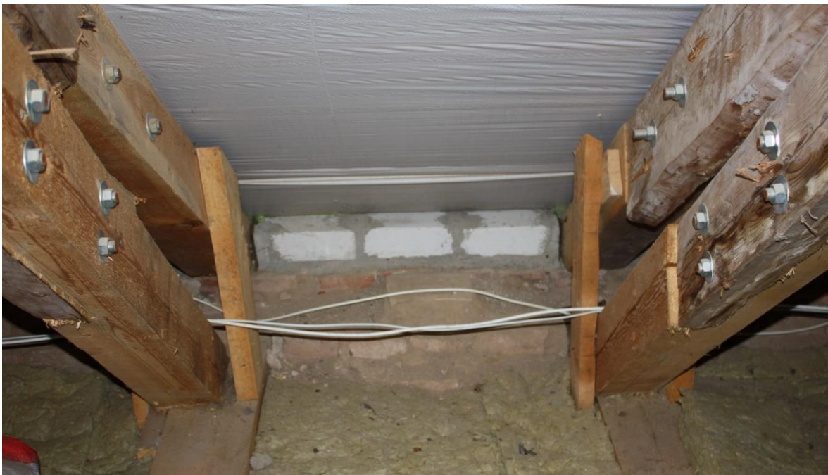
Joonis 44 – Karniisi vasturaskus asendatud soojustusmaterjaliga, karniisiäärele laotud silikaatkivid – Vali, J. fotokogu
