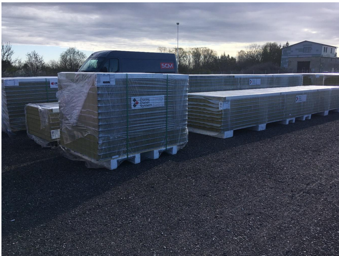
Joonis 1.2 Kivivill soojustusega sändvitšpaneelide ladustamine ehitusobjektil – paneeli otsad avatud, soojustus saab märguda (Kalamees)
