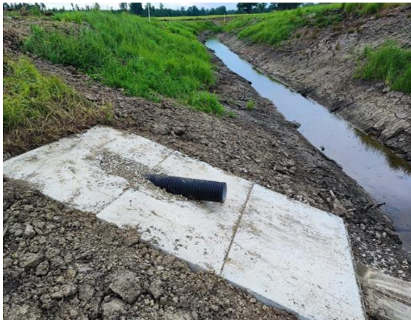
Pilt 2.9 Kindlustatud suue betoonplaadiga avaga 315 mm Kõrtsi oja [6]
