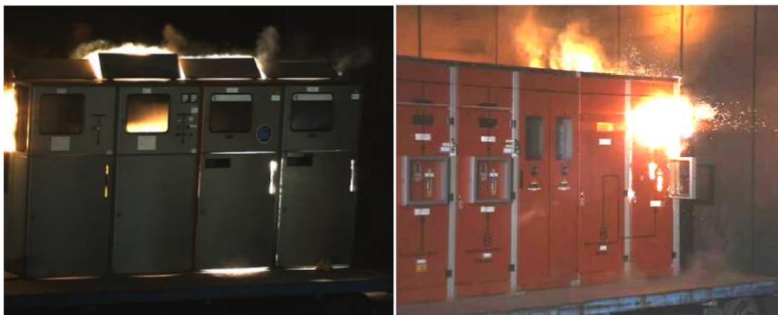
Joonis 1.13 Keskpinge võimsuslülitite vigastumine maksimaalselt lubatava lühisvooluga katsetamisel [32]
