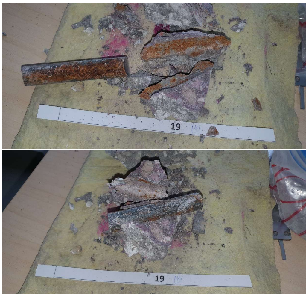
Joonis 3.7 Katsekeha 19Ü sisemine korrosiooniuuring
