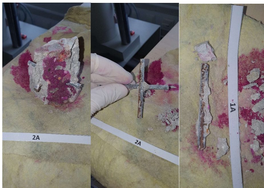
Joonis 3.5 Katsekehade 1A ja 2A sisemine korrosiooniuring
