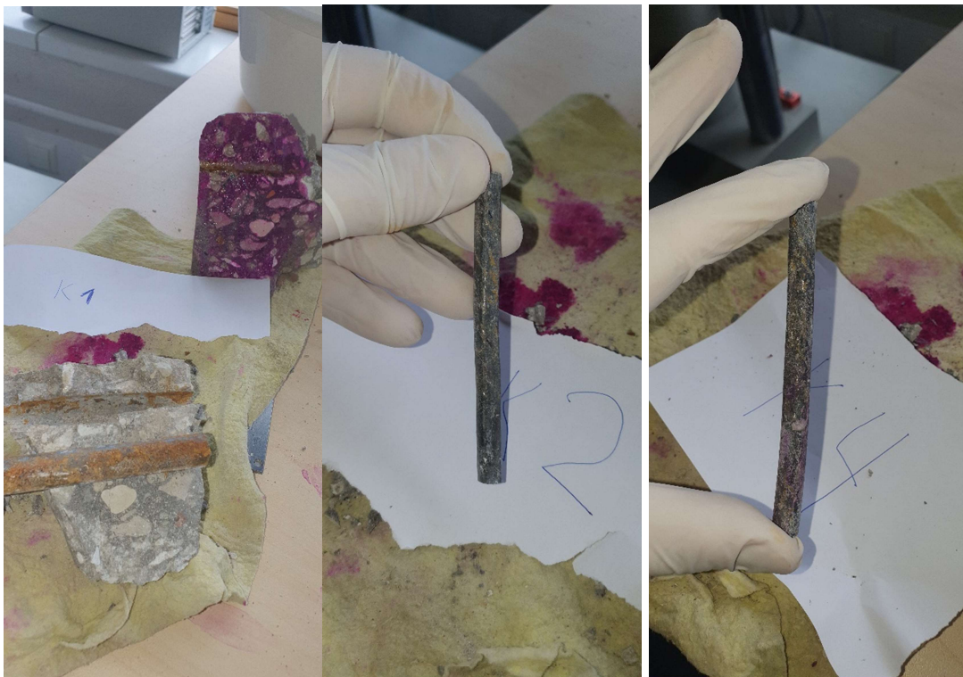
Joonis 3.8 Katsekeha K1, K2 ja K4 sisemine korrosiooniuuring
