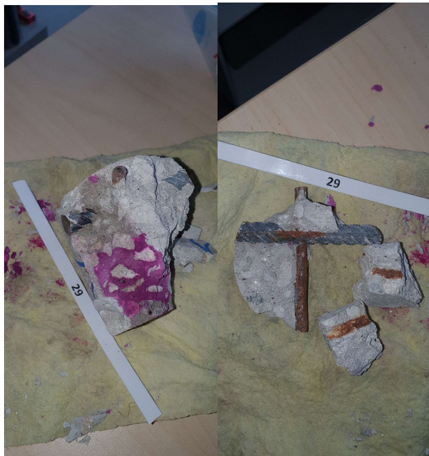
Joonis 3.9 Katsekeha 29 sisemine korrosiooniuring
