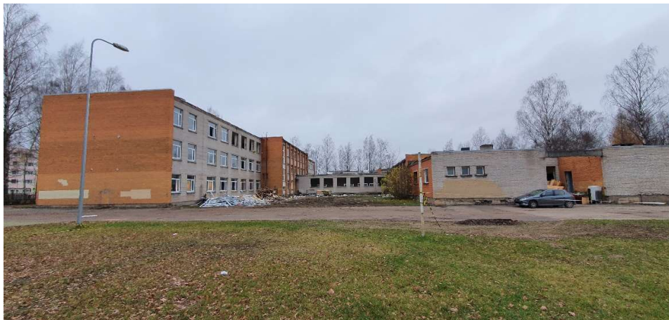
Joonis 2.2 Erinevate materjalidega parandatud välisfassaad, pildistatud idakaarest (16.11.2020)
