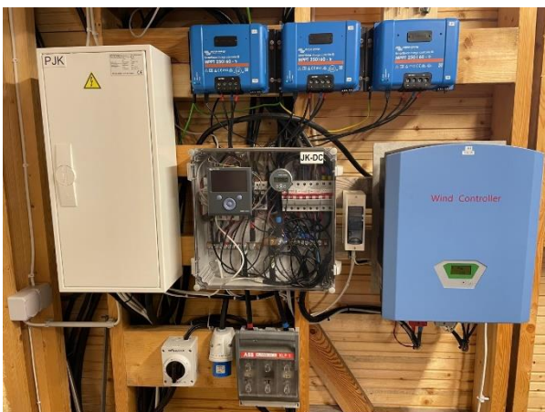
Joonis 3.24 Kontrollerid koos inverteriga
