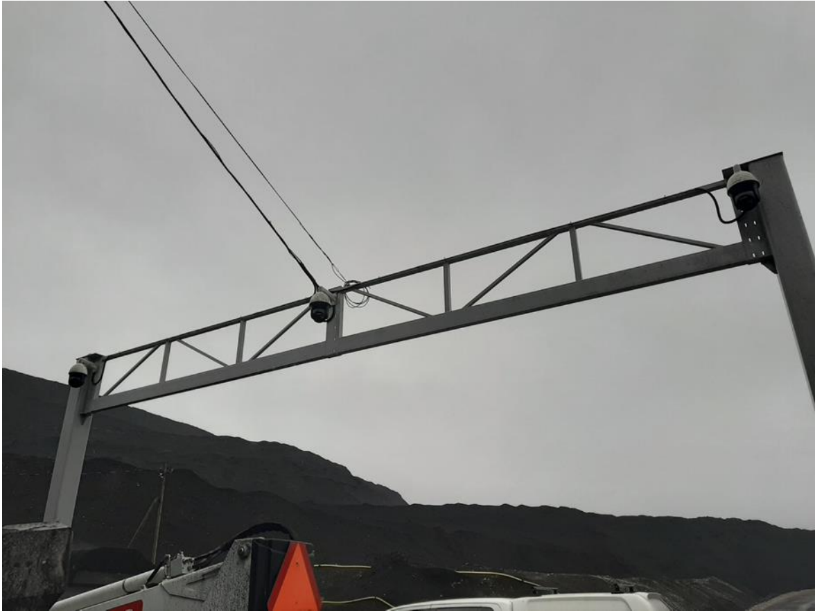
Рисунок 6. Расположение камер на металлоконструкции.
