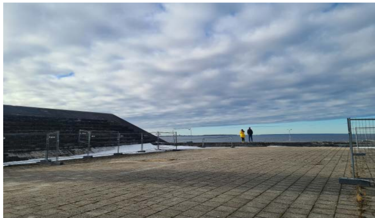
Foto 29. Maarjamäe memoriaalkomplekti hetkeseisukord - lagunemisohtlik, aga kasutuses. (Autori foto)
