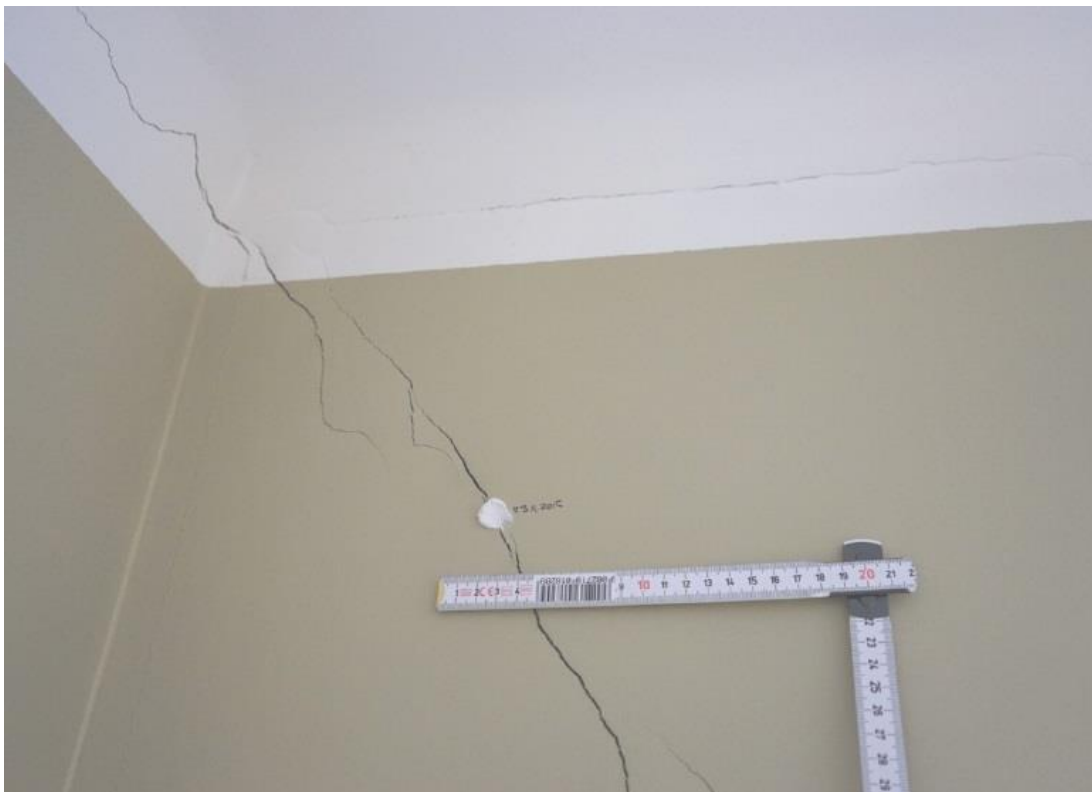
Joonis 13. Kaitseliidu Peastaabi hoone B-korpuse 4. korruse edelanurga kabineti seinale tekkinud pragu, millele paigaldati kipsmajakas 23.11.2015. Foto on tehtud 16.03.2016 toimunud paikvaatlusel. Kipsmajakas on terve. (Kase 2016)
