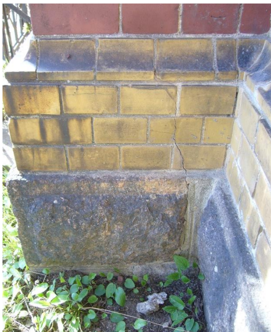
Foto 37. Soklit läbiv pragu peafassaadil. (Foto: autor, 04.05.2015)
