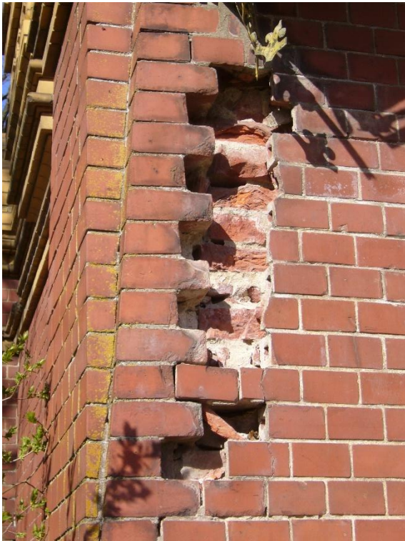
Foto 41. Kahjustused varikatuse vasakpoolse serva all. (Foto: autor, 04.05.2015)
