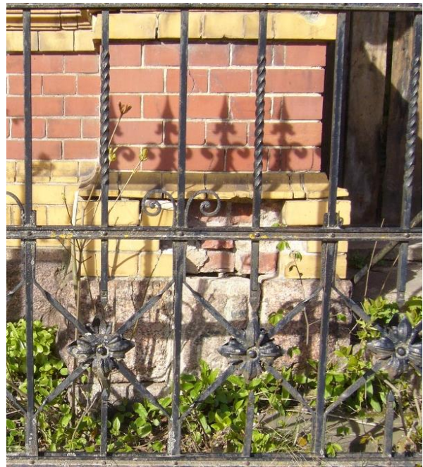
Foto 38. Puuduvad kivid soklisimsilt peafassaadil. (Foto: autor, 04.05.2015)
