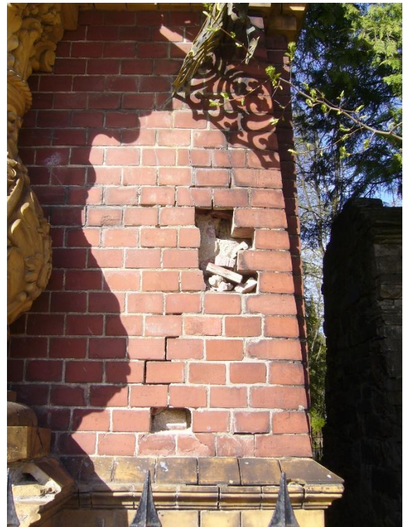
Foto 42. Kahjustused varikatuse parempoolse serva all. (Foto: autor, 04.05.2015)
