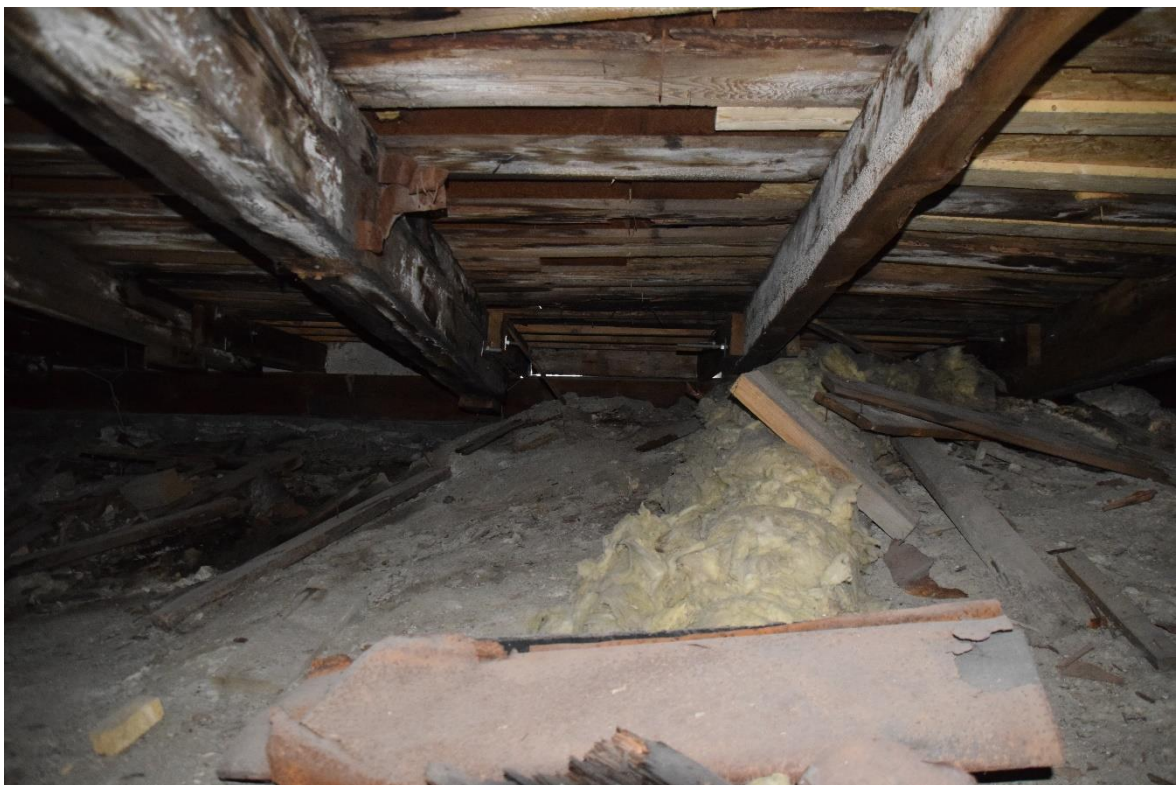
Foto 25. Ruumi 3010 merepoolse osa sarikaotsad ja kahjustatud müürlatt.
