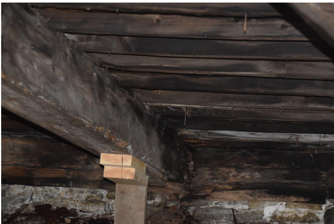
Foto 71. Toestatud ja kahjustatud sarikas ruumide 3110 ja 3115 vaheseina kohal.
