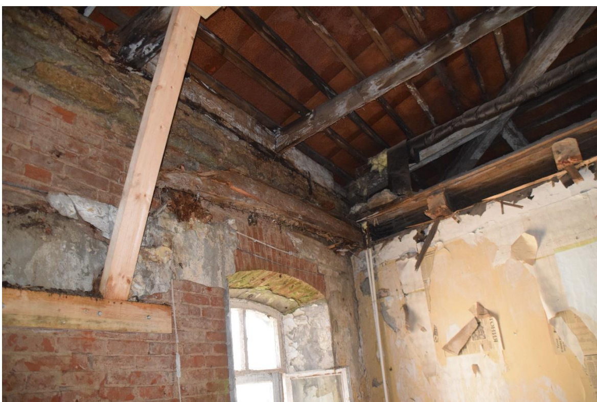
Foto 205. Kahjustatud ja toestatud vahelae talad ruumis 3256.
