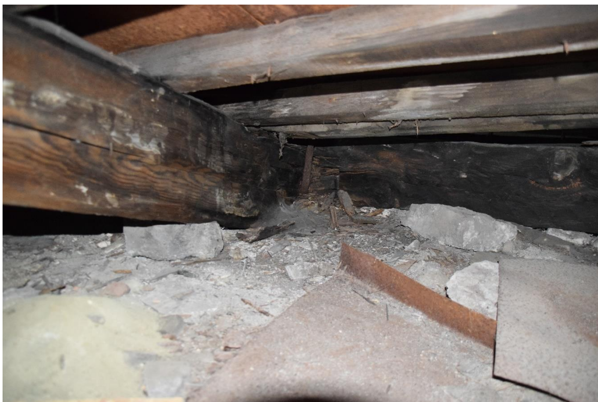
Foto 4. Kahjustatud sarikaots ja müürlatt ruumi 3001 kohal.
