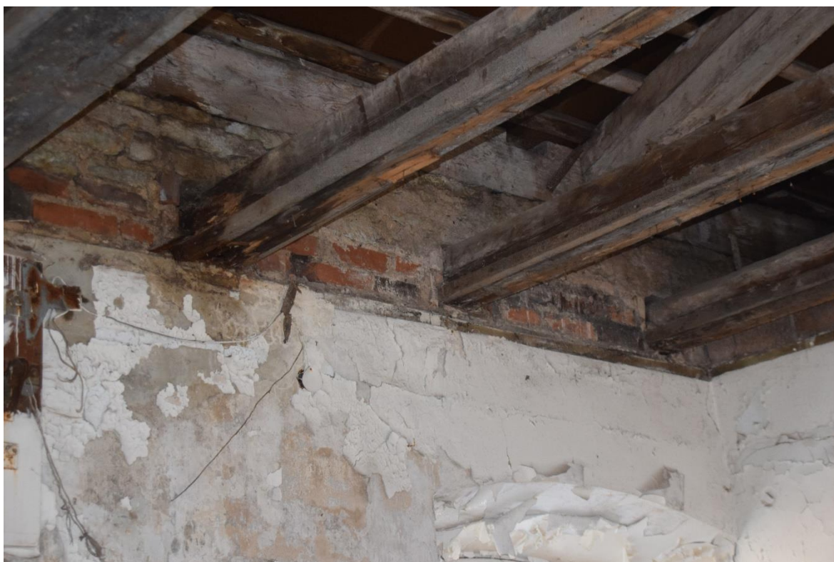
Foto 190. Kahjustatud vahelae talad ruumis 3220.
