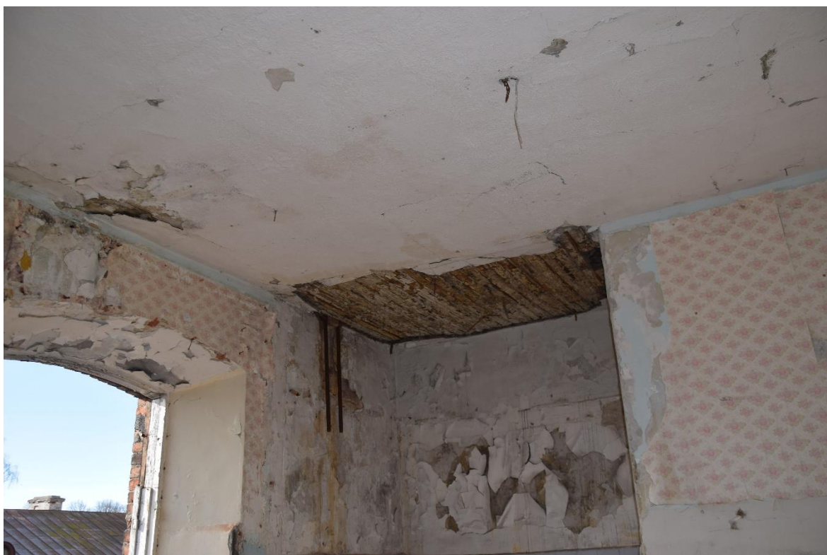
Foto 196. Majavammi kahjustusega vahelagi ruumis 3241.
