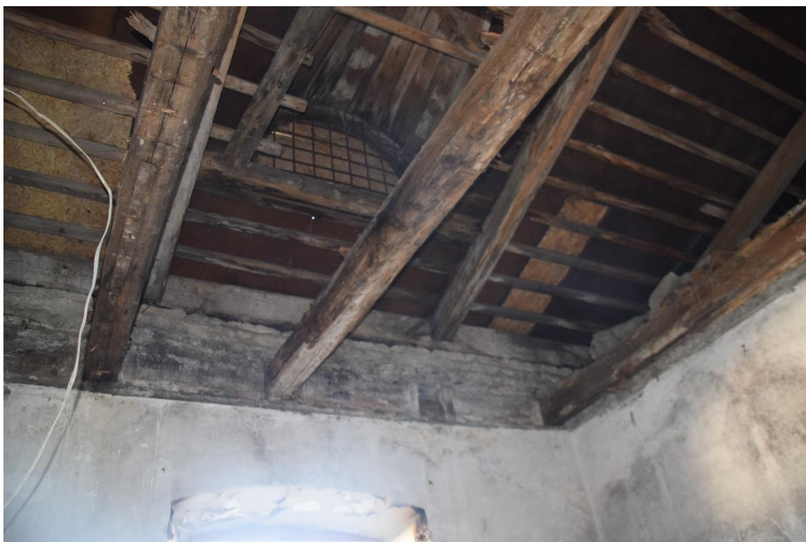
Foto 170. Tugeva kahjustusega vahelae talad ruumi 3181 kohal.
