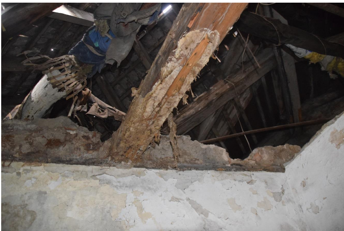
Foto 204. Majavammi kahjustusega tala ruumis 3255. Proov P35.
