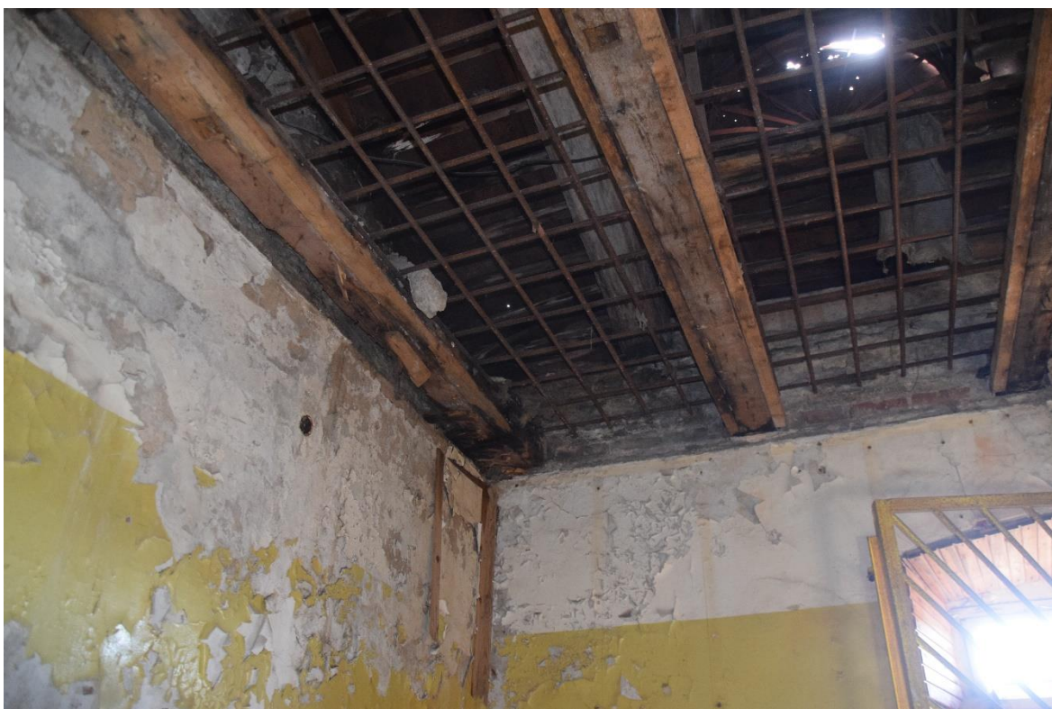
Foto 193. Ruumi 3228 kahjustatud vahelae talad.
