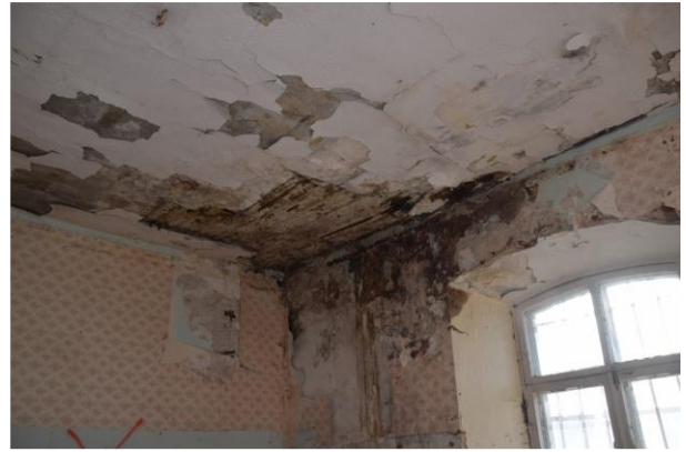
Joonis 7.1812 Proovi P34 võtukoht ruumis 3241, kus on näha majavammi kahjustustega lage (autorifoto)
