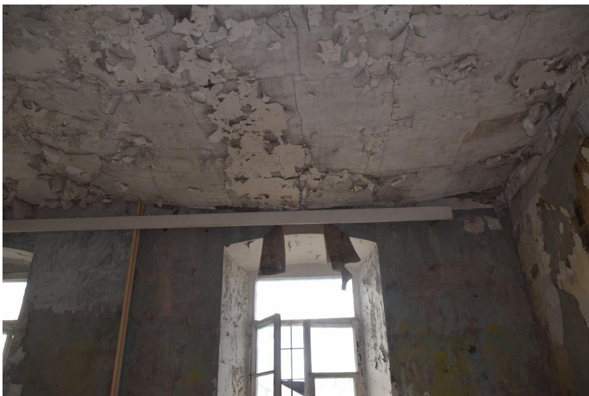
Foto 198. Kahjustatud vahelagi ruumis 3237.
