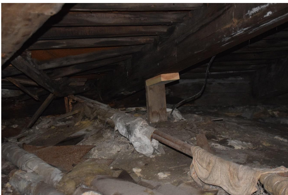
Foto 73. Kahjustatud ja toetatud sarikaots ruumi 3115 välisseina kohal.
