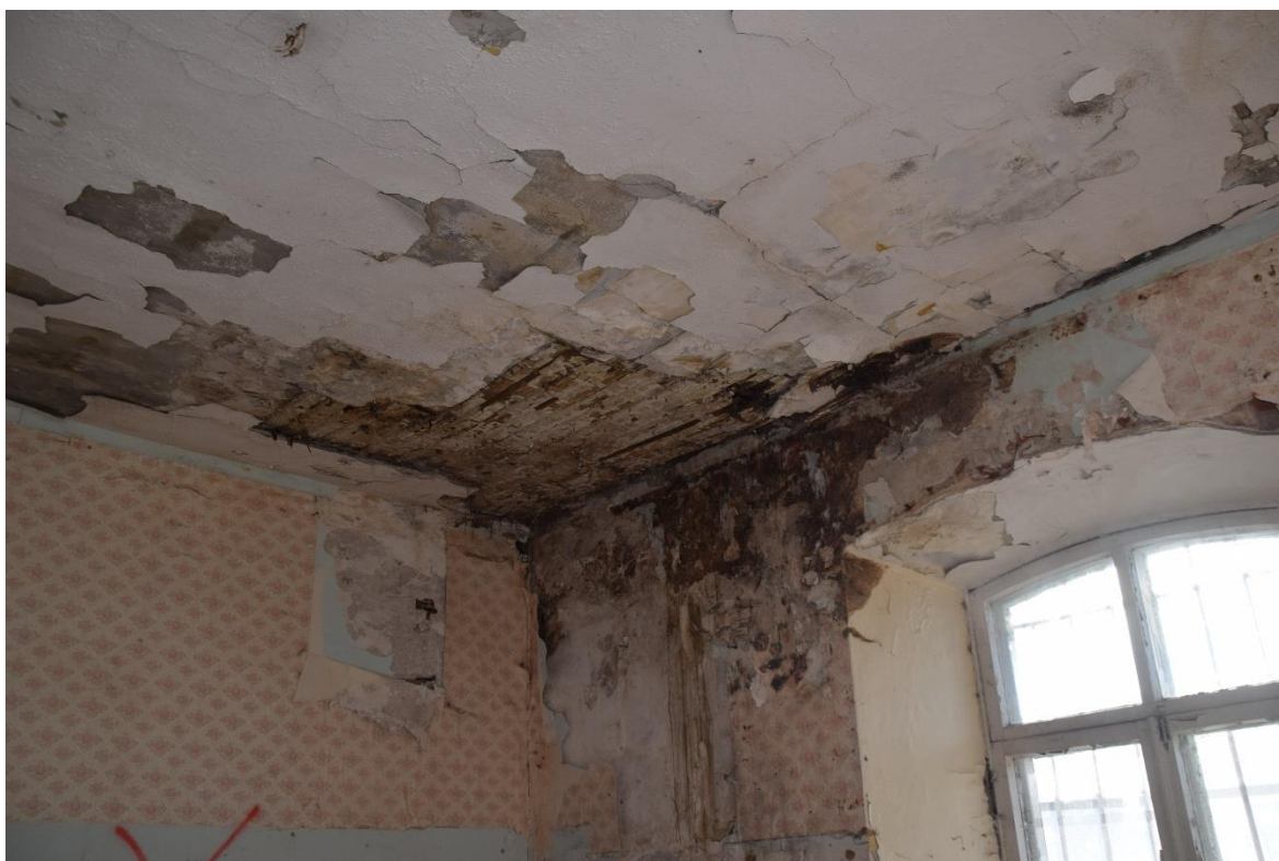
Foto 194. Majavammi kahjustusega vahelagi. Proov P34. Resitograafi puurimised 72-74.
