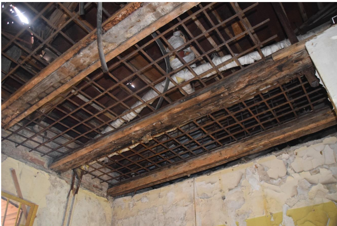
Foto 192. Ruumi 3228 kahjustatud vahelae talad.
