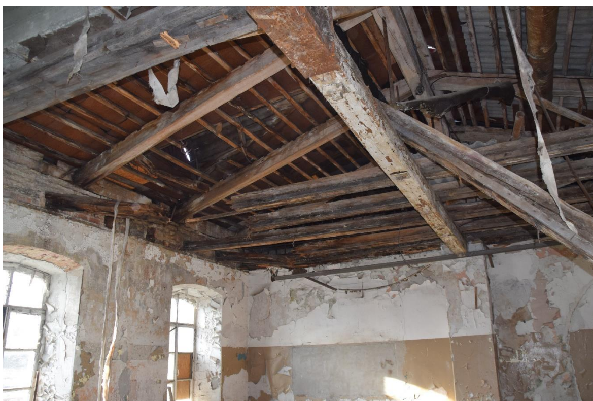
Foto 187. Seenkahjustusega vahelae talad ruumis 3220. Mitmed talad purunenud.
