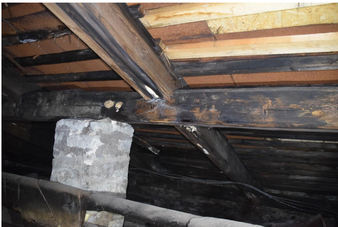
Foto 58. Seenkahjustusega sarikas koridori kohal. Proovi P14 võtukoht.
