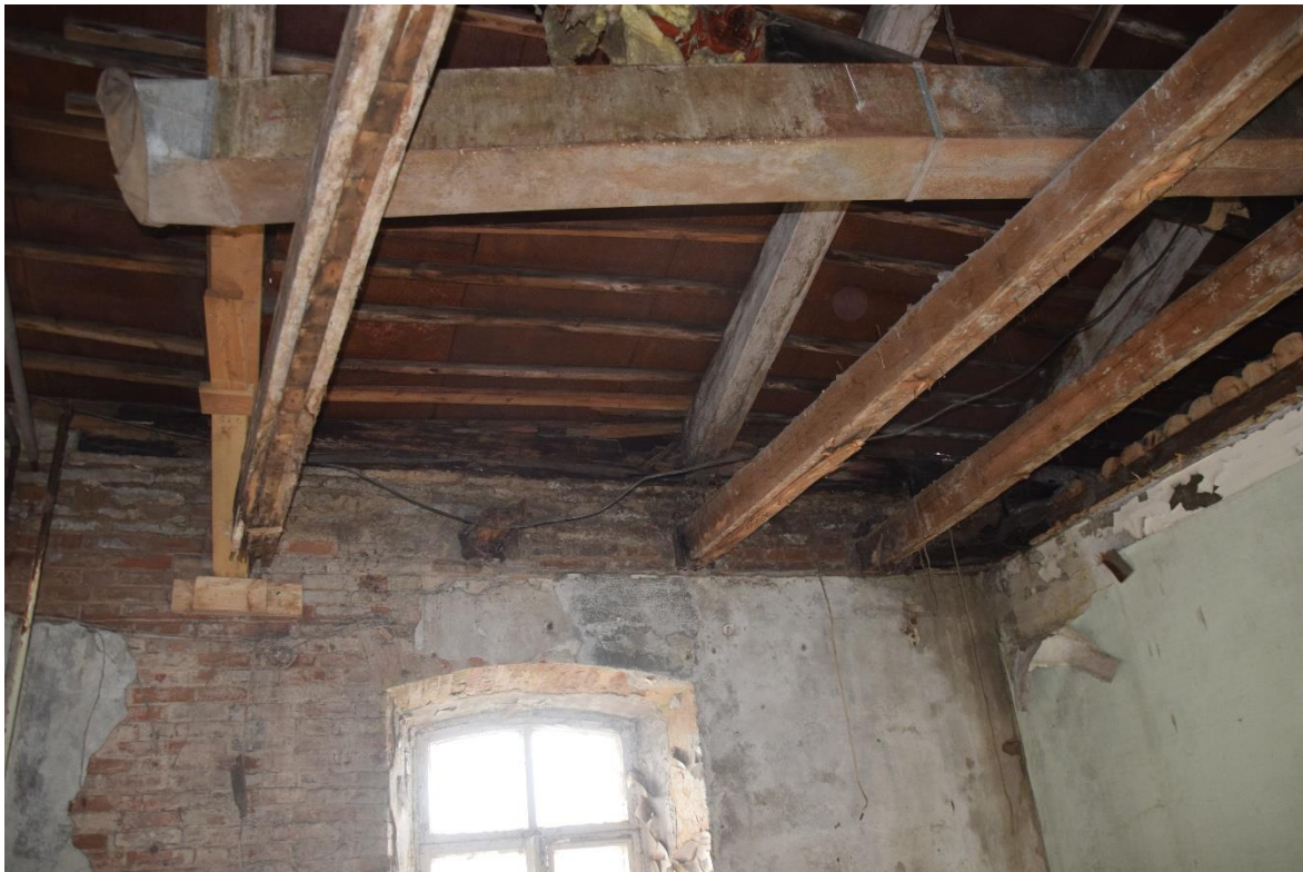
Foto 202. Kahjustatud vahelae talad ruumis 3250.
