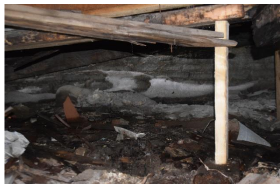
Joonis 7.7 Lume ja vee läbijooks katusest otse konstruktsioonile (autorifoto)
