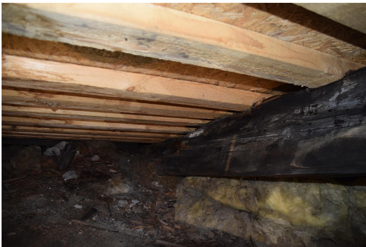
Foto 12. Seenkahjustusega sarikas ruumi 3012 kohal.
