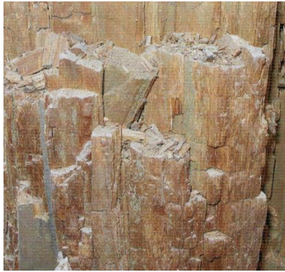
Joonis 2.4 Pruunmädaniku kahjustatud puit[2]
