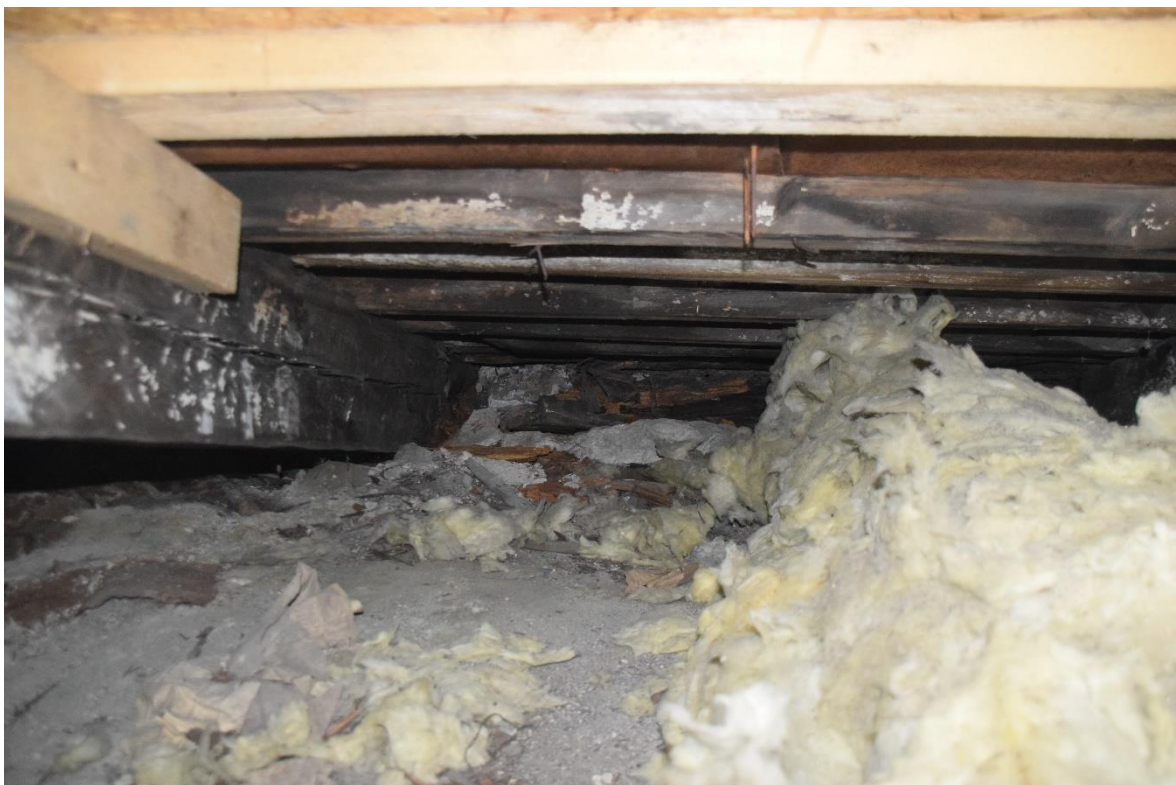
Foto 7. Tugevdatud sarikas ja kahjustatud müürlatt ruumi 3003 kohal.
