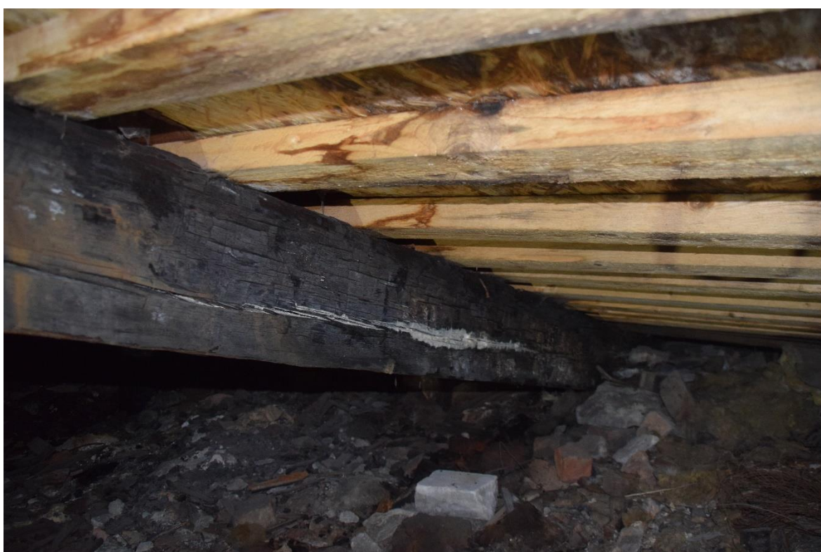
Foto 13. Seenkahjustusega sarikas ruumi 3012 kohal.
