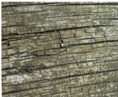
Joonis 2.3 Pehmemädaniku kahjustatud puit[2]
