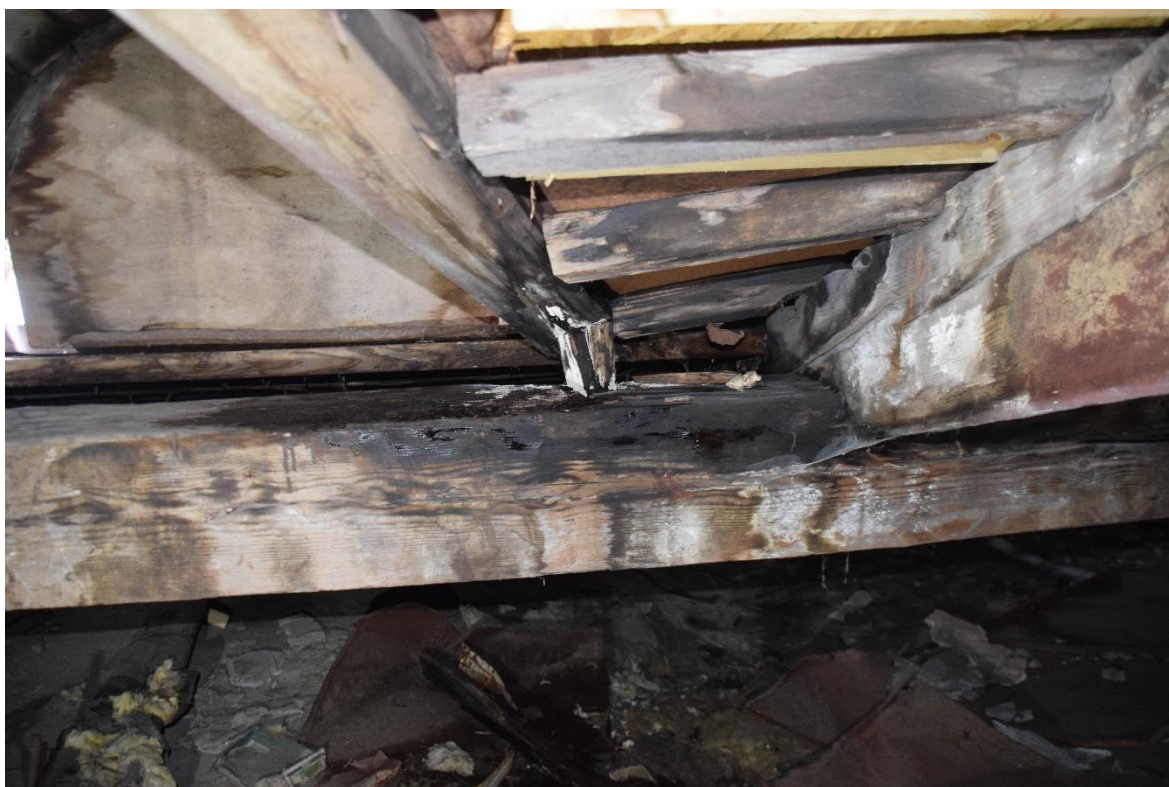
Foto 54. Kahjustatud toolvärgi vöö uugi all ruumi 3131 kohal merepoolses osas.
