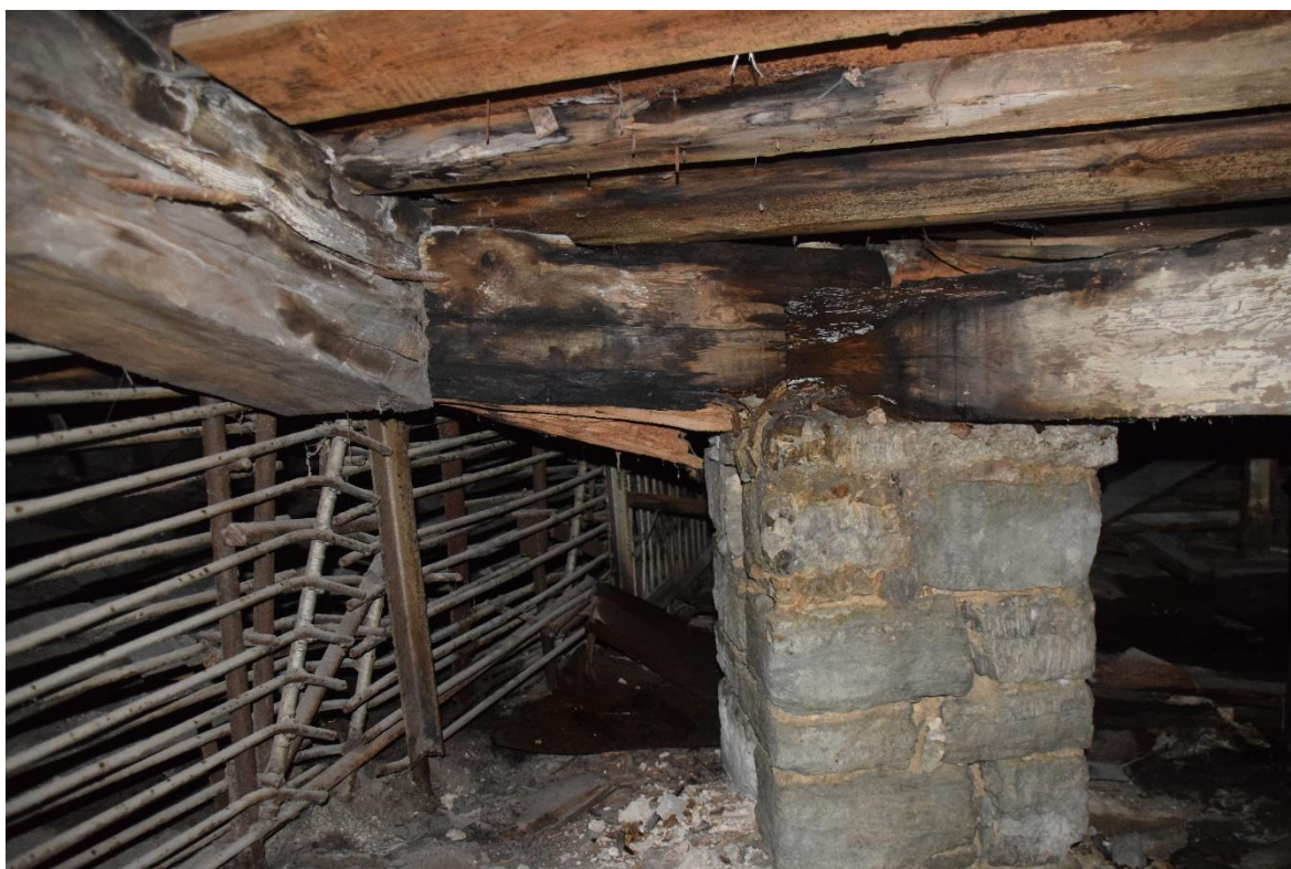
Foto 34. Kahjustatud sarikad trepikoja kohal neelukohas. Proovi P4 võtukoht.
