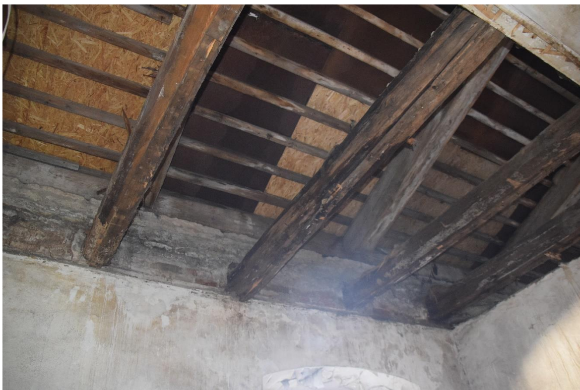
Foto 172. Tugeva kahjustusega vahelae talad ruumi 3184 kohal.
