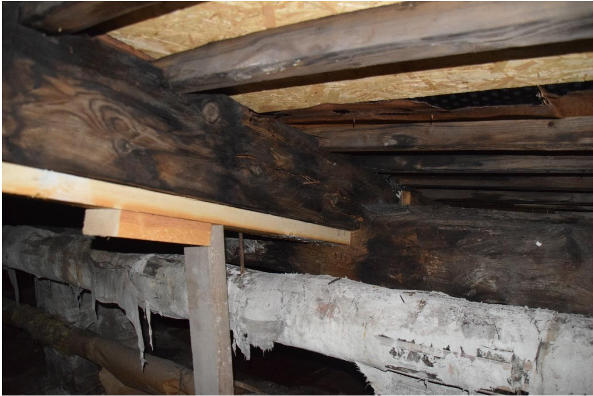
Foto 46. Kahjustatud sarikas ruumi 3079 kohal. Proovi P9 võtukoht.
