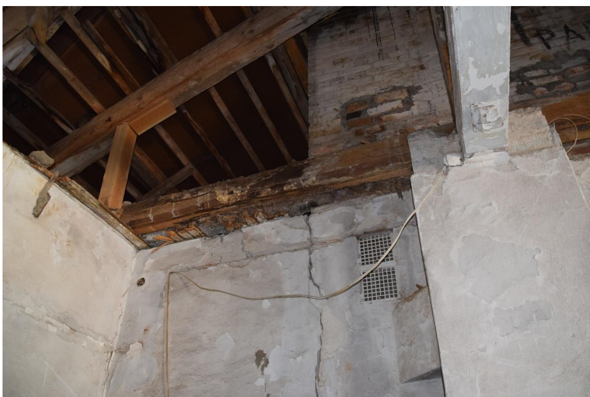
Foto 179. Kahjustatud vahelae tala ruumi 3196 kohal.
