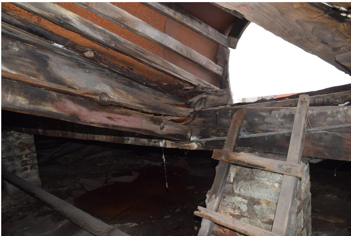
Foto 56. Kahjustused uugi all ruumi 3121 kohal. Proovi P13 võtukoht.
