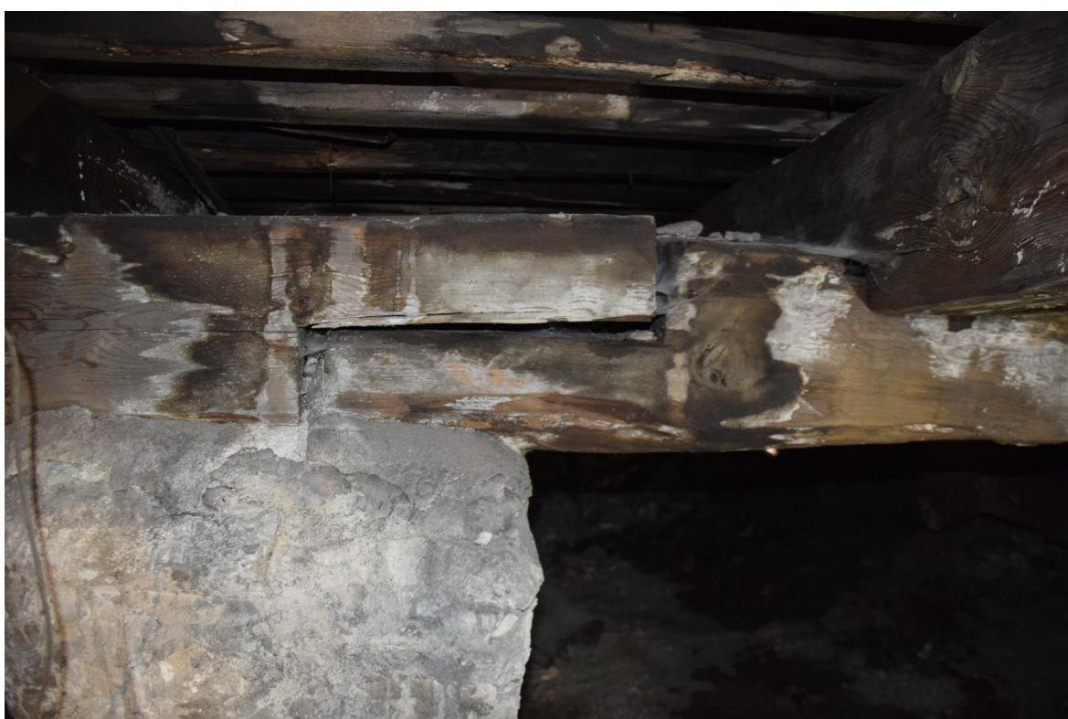
Foto 17. Deformeerunud toolvärgi hoovipoolne vöö ruumi 3005 kohal.
