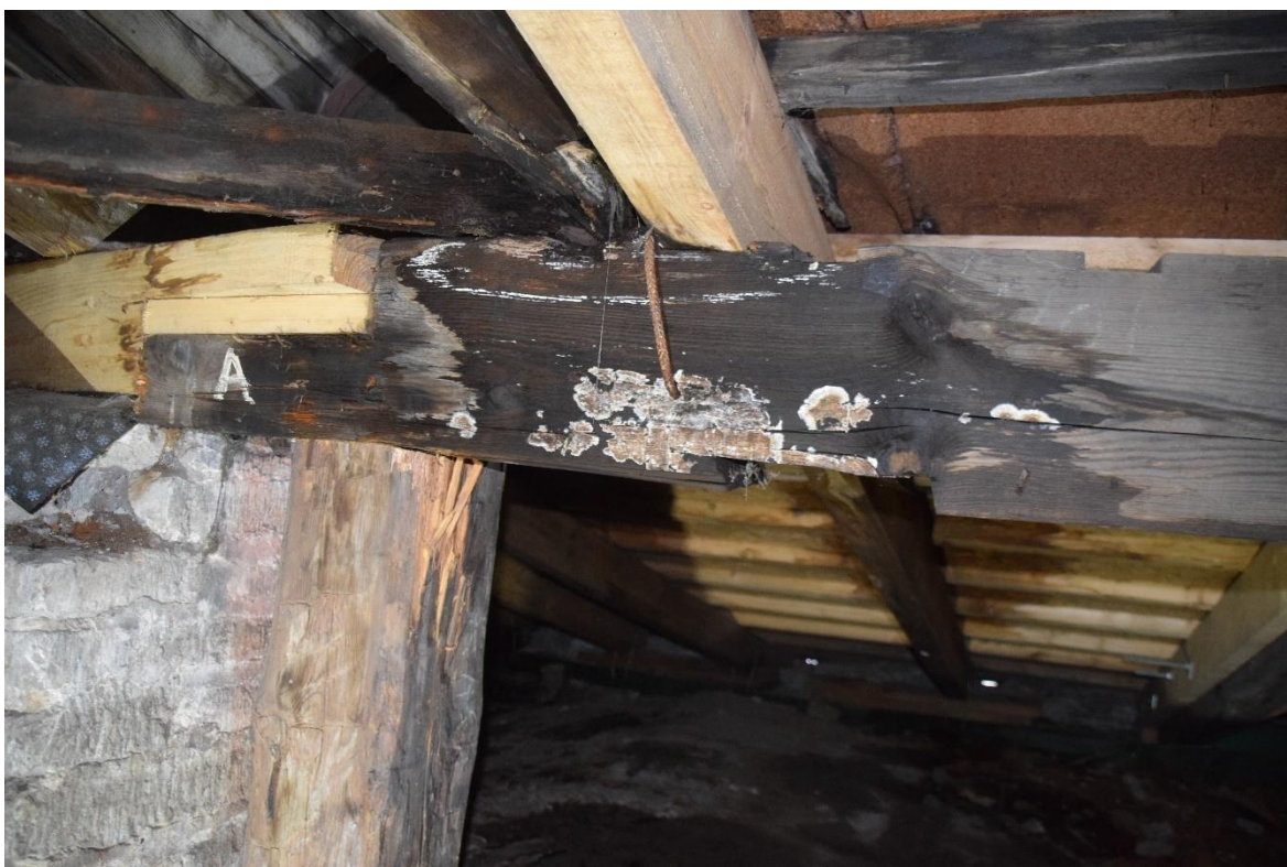
Foto 65. Kahjustatud toolvärgi vöö ja sarikas uugi all. Proovi P17 võtukoht.
