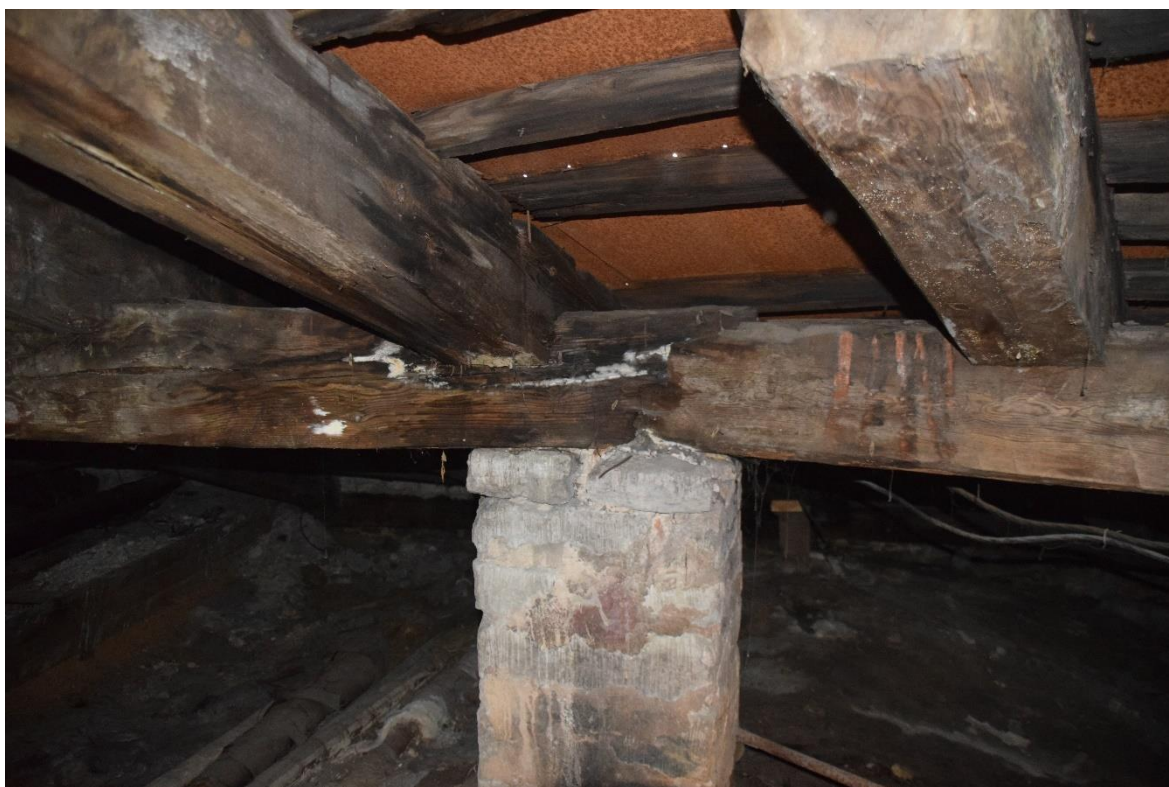
Foto 72. Kahjustatud toolvärgi vöö ruumi 3115 kohal.
