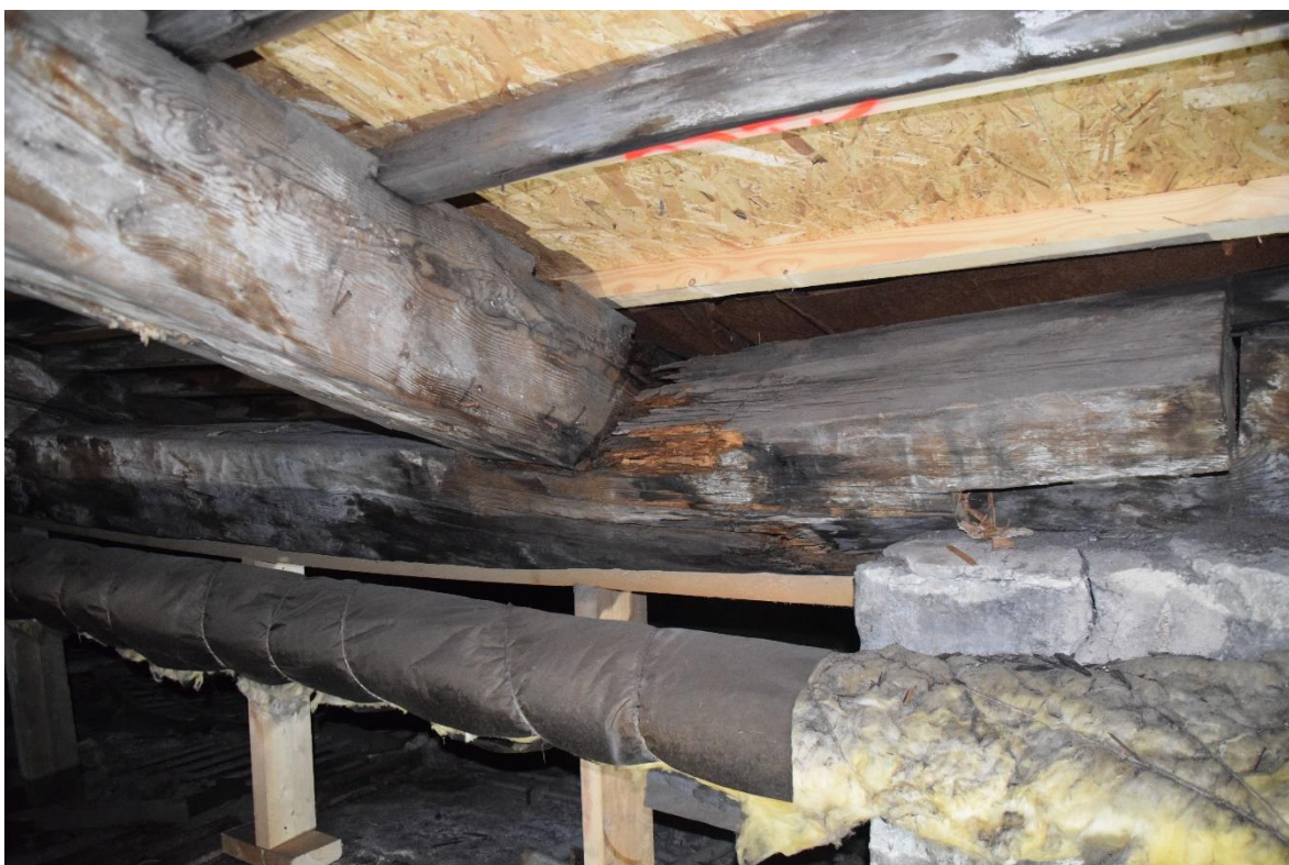
Foto 39. Vändunud toolvärgi vöö ruumide 3073 ja 3074 vaheseina kohal.
