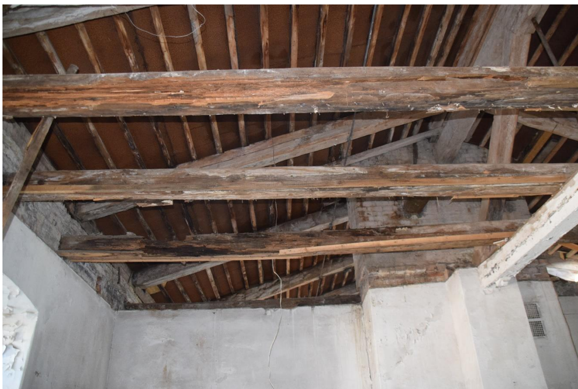
Foto 182. Kahjustatud talad ruumi 3197 kohal.
