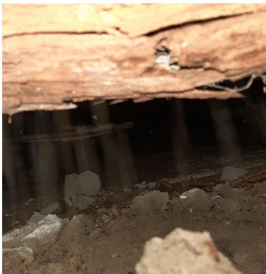
Foto 195. Vaade vahelae konstruktsiooni. Näha purunenud tala.
