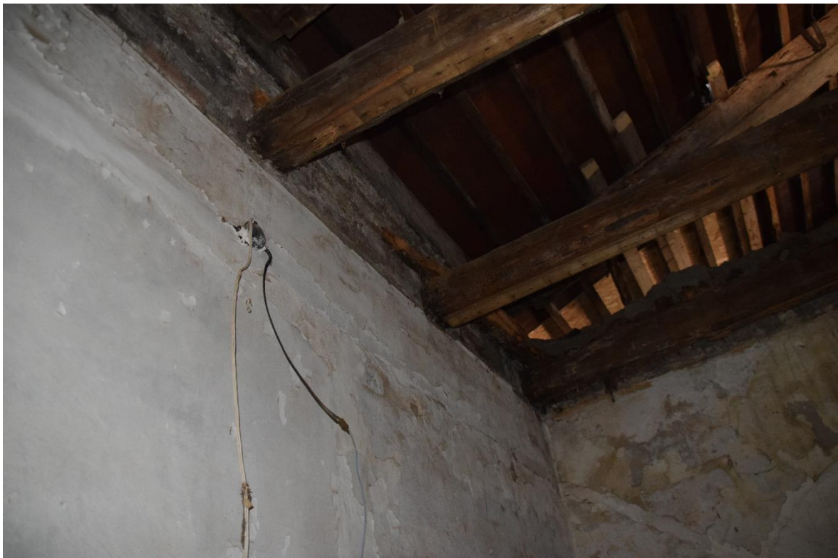
Foto 177. Tugeva kahjustusega vahelae talad ruumi 3191 kohal.
