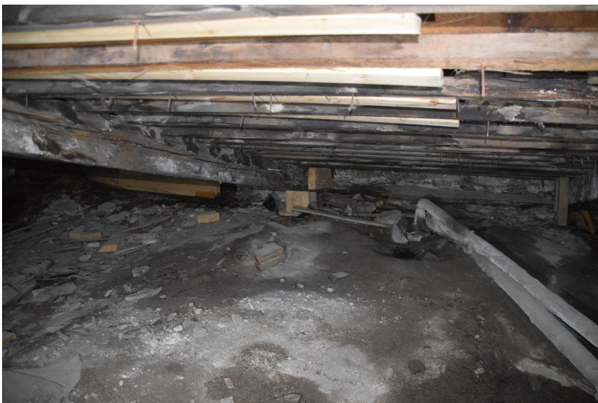
Foto 53. Kahjustused ruumi 3092 kohal. Neelukoht Lüneti tiiva katusega.
