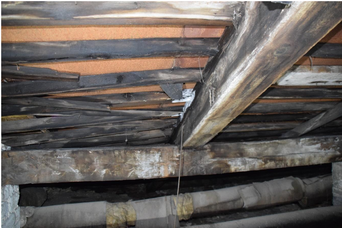
Foto 60. Kahjustatud sarikas ruumi 3104 kohal. Proovi P15 võtukoht.
