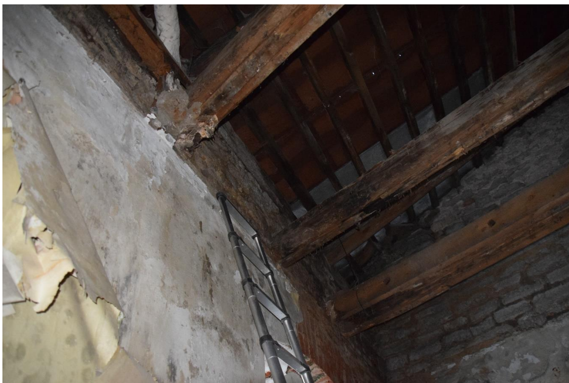
Foto 163. Kahjustatud vahelae talad ruumi 3021 kohal. Proovi P26 võtukoht.
