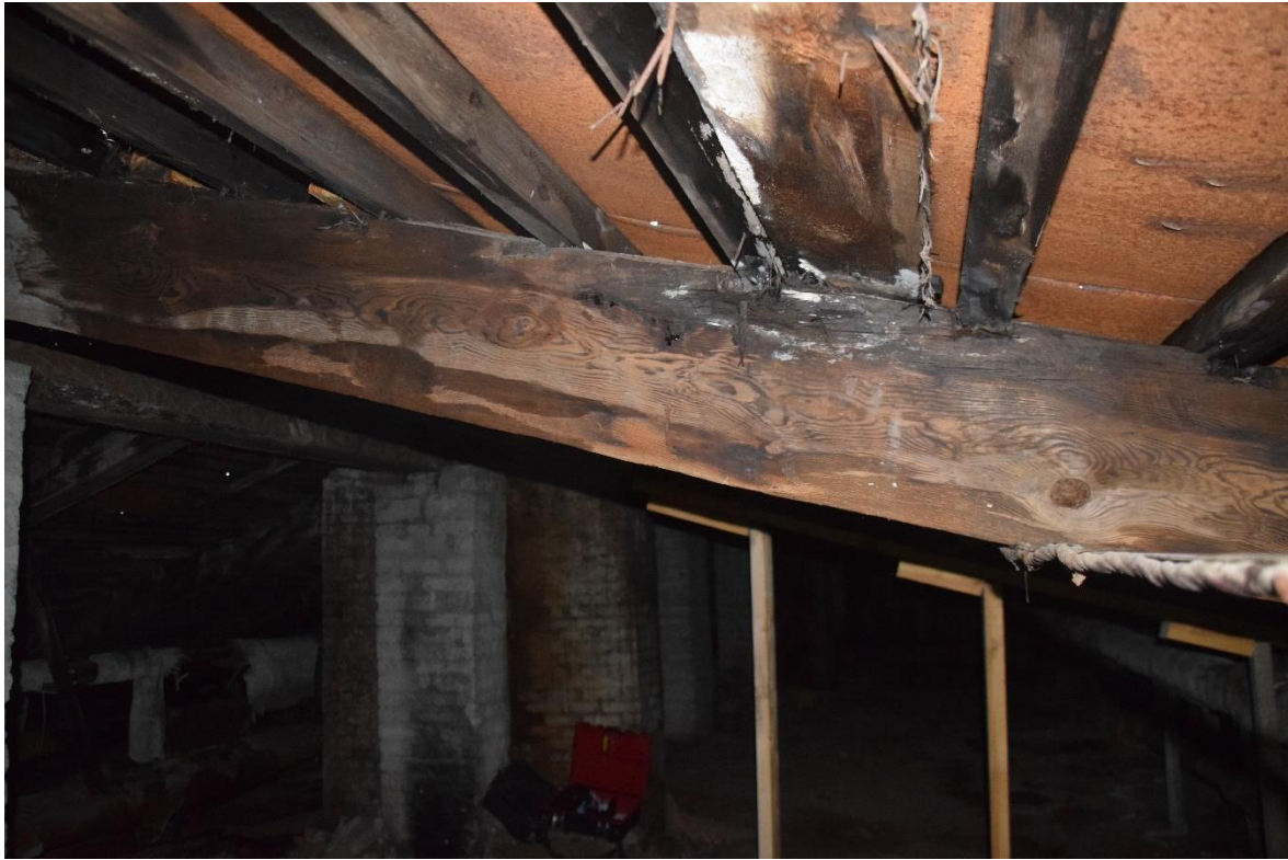
Foto 44. Kerge kahjustusega sarikas ja roovid ruumide 3080 ja 3081 vaheseina piirkonnas.
