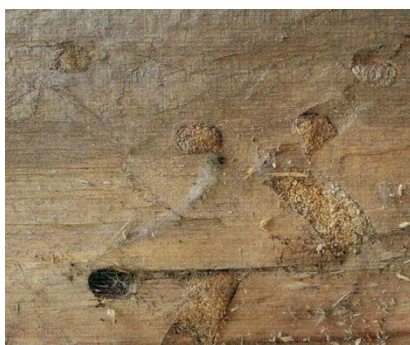
Joonis 2.9 Siklaste kahjustatud puit[2]
