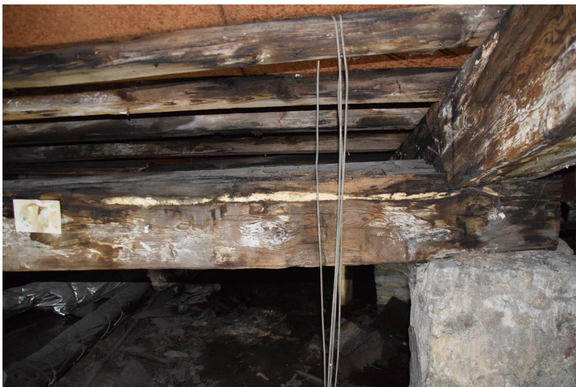
Foto 36. Tugevasti kahjustatud toolvärgi vöö ja sarikas uugi kõrval. Proovi P6 võtukoht.
