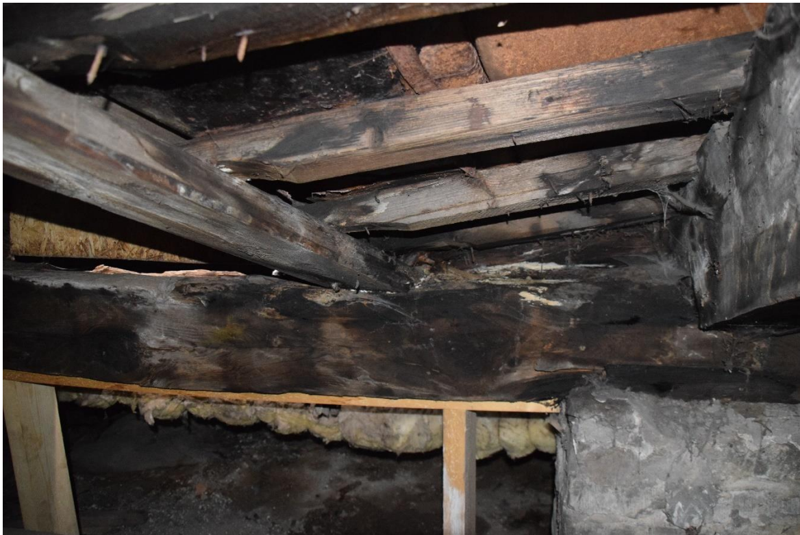
Foto 50. Kahjustatud toolvärgi vöö ruumi 3087 kohal merepoolses osas. Proovi P11 võtukoht.
