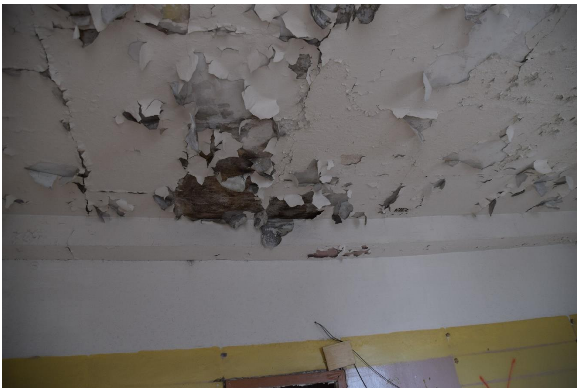
Foto 200. Sademevee lekke ja seenkahjustuse tunnused ruumis 3249.
