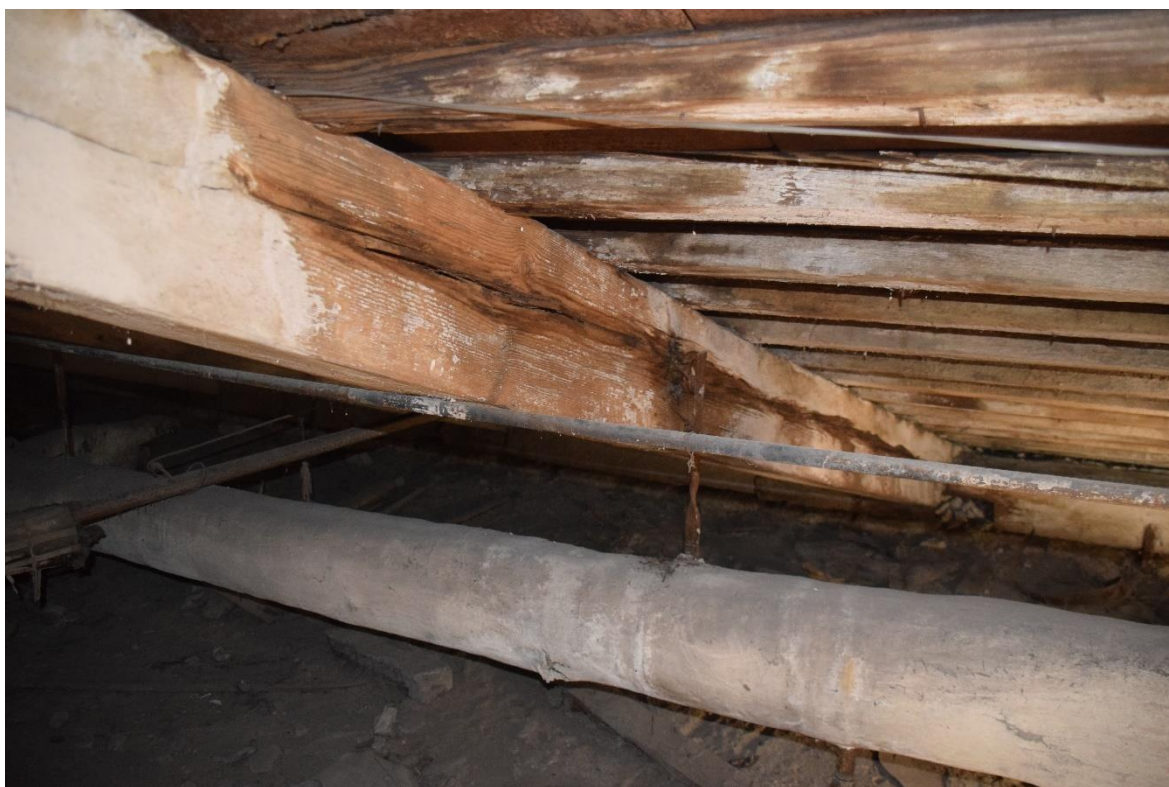
Foto 78. Kahjustatud sarikas ruumi 3023 kohal resistograafi puurimised 40 ja 41.
