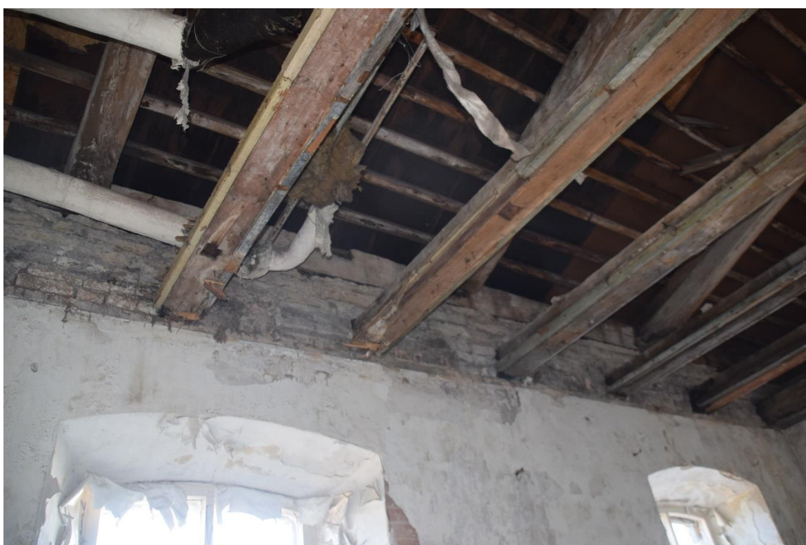
Foto 183. Majavammi kahjustusega vahelae talad ruumi 3198 kohal. Proov P32.
