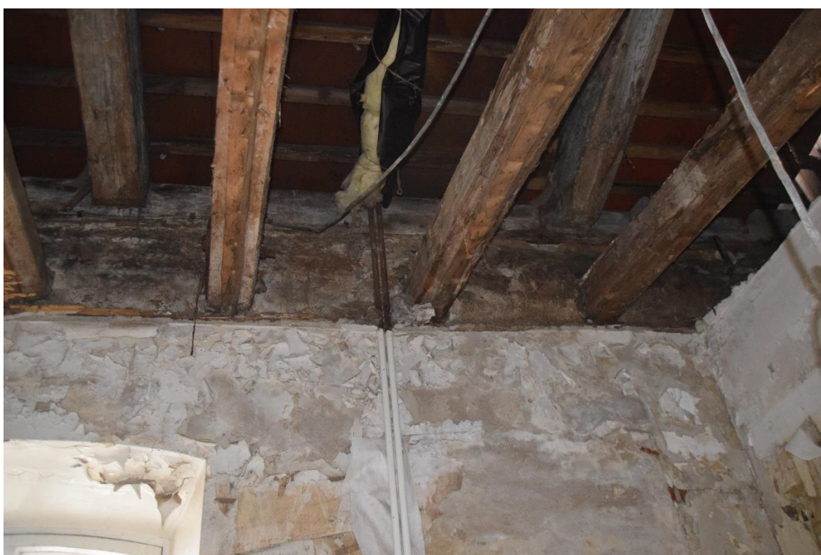
Foto 201. Kahjustatud vahelae talad ruumis 3259.
