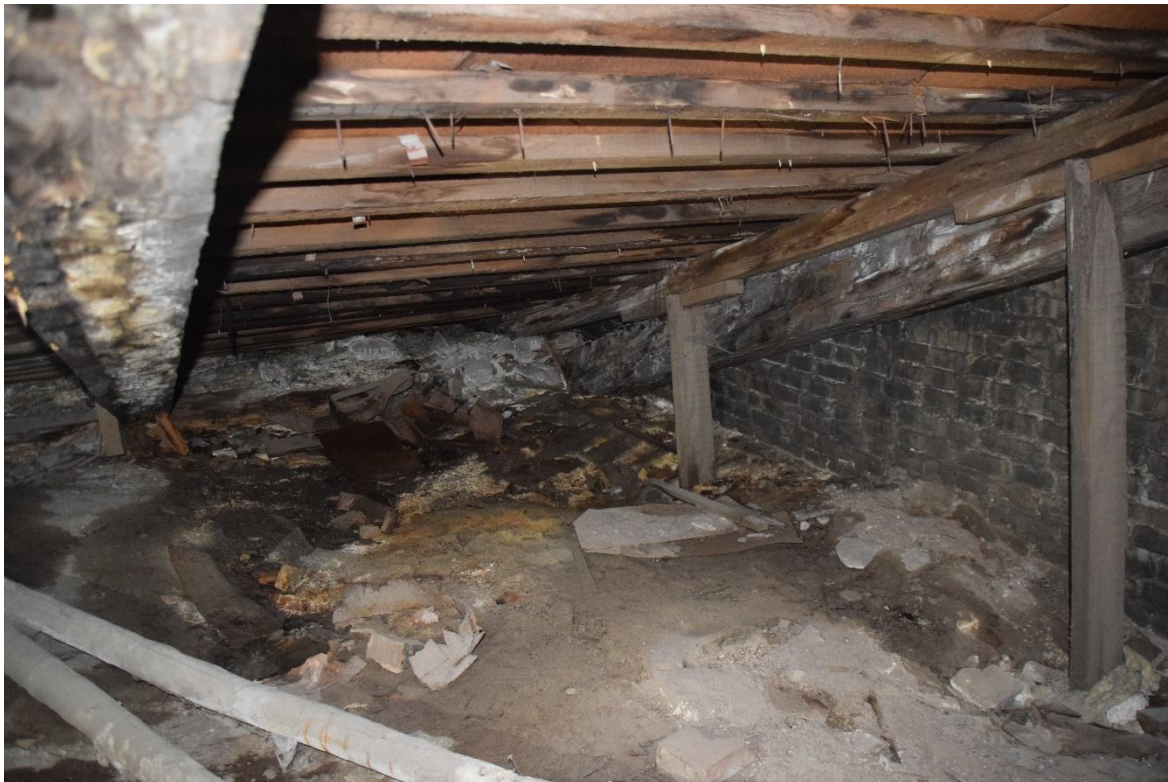
Foto 52. Kahjustused ruumi 3091 kohal.
