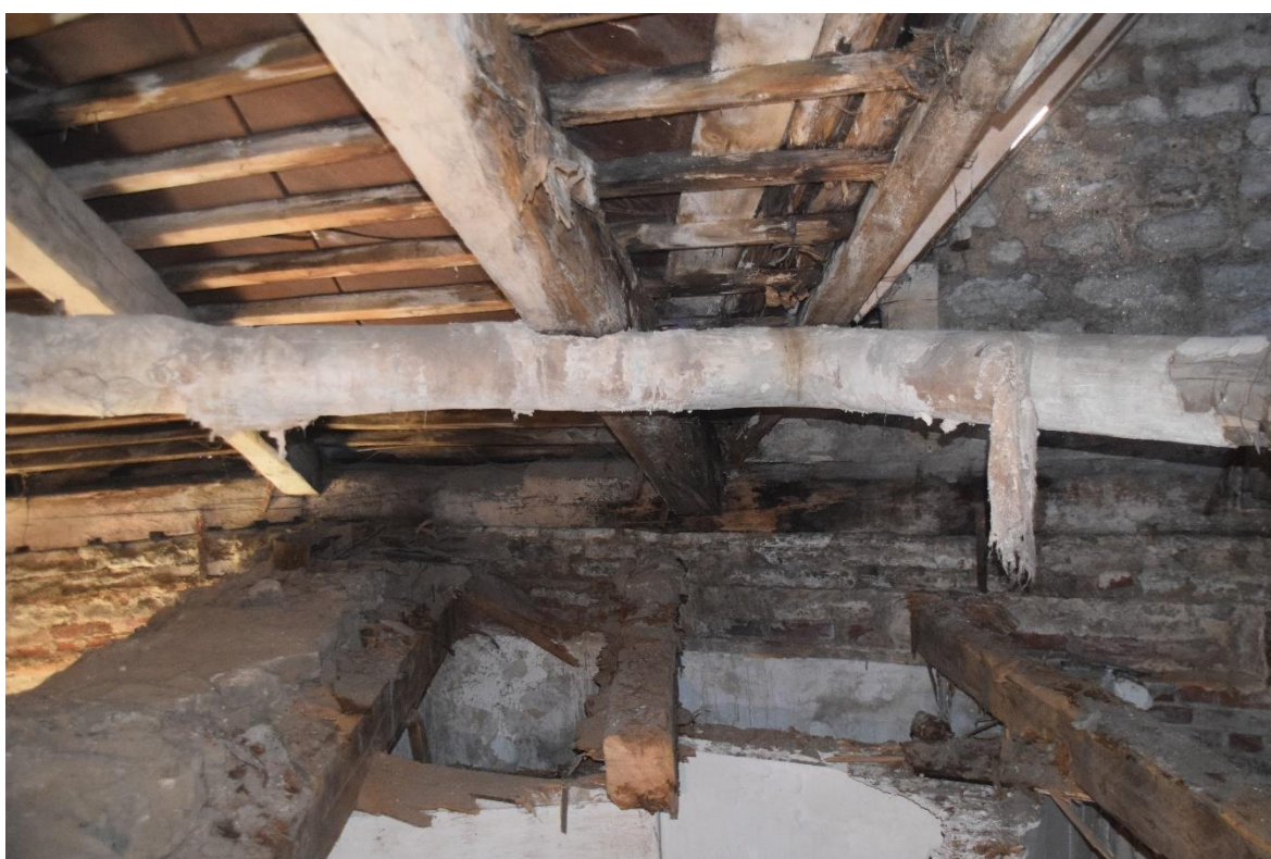
Foto 85. Kahjustatud neelukoha sarikad ruumi 3180 kohal.
