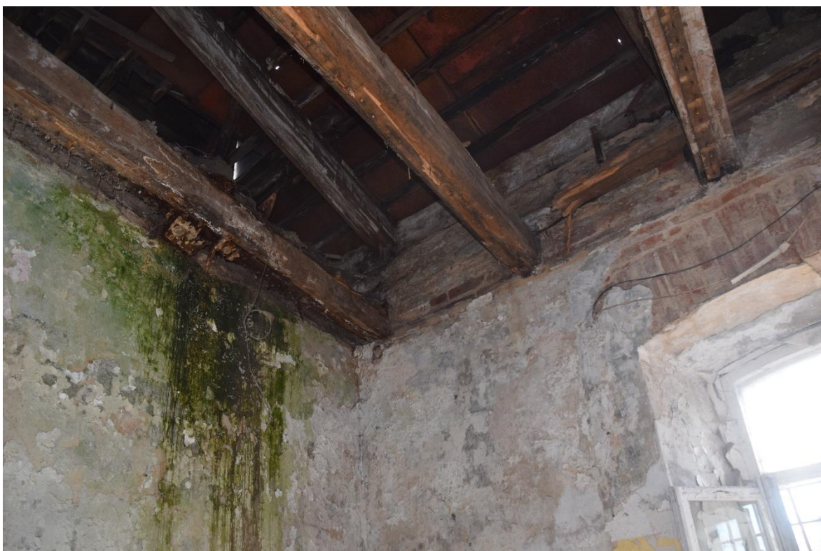
Foto 203. Kahjustatud vahelae talad ruumis 3253.
