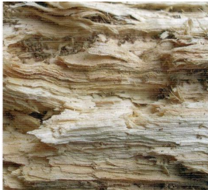
Joonis 2.5 Valgemädaniku kahjustatud puit[2]
