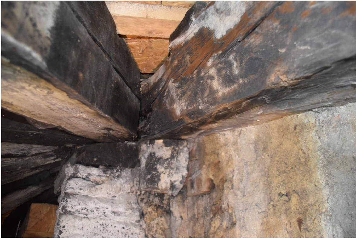
Foto 6. Kahjustatud sarikaots toesõlmes ruumi 3003 kohal.
