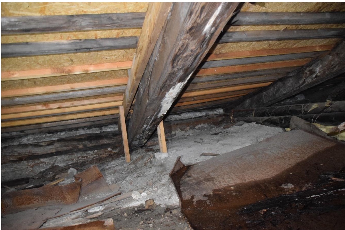
Foto 47. Kahjustatud sarikas ruumi 3079 kohal. Proovi P9 võtukoht.
