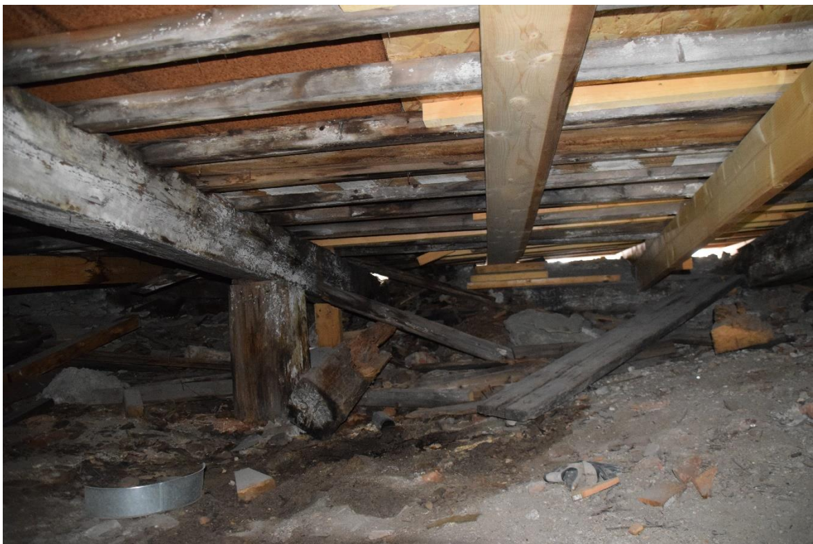
Foto 33. Kahjustatud sarikad ja müürlatt ruumi 3059 kohal.
