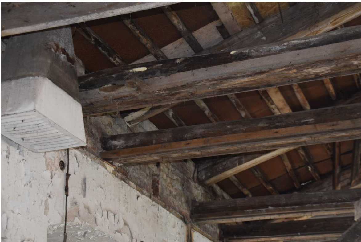
Foto 189. Kahjustatud vahelae talad ruumis 3220.
