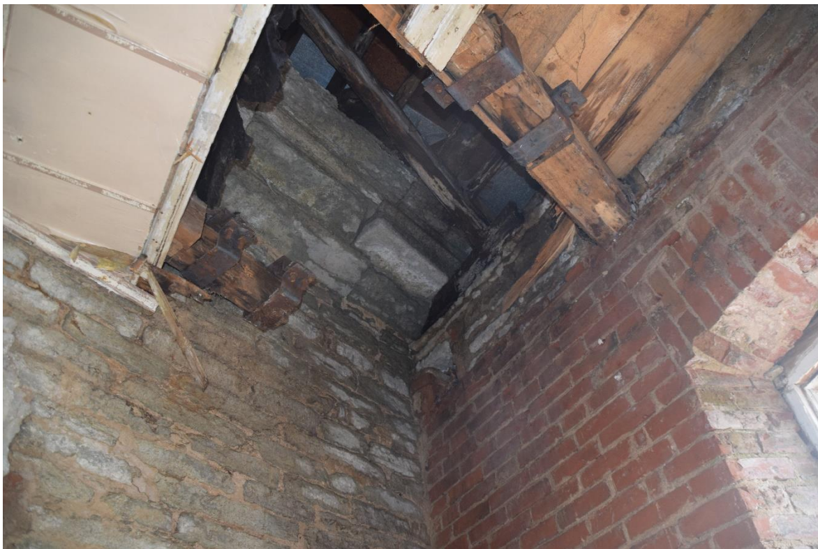
Foto 209. Kahjustatud välisseina nurk ruumis 3120.
