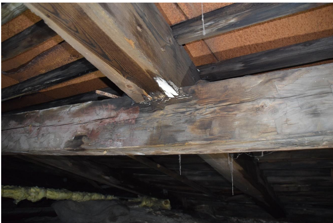
Foto 69. Kahjustus sarika ja toolvärgi ühenduskohas ruumi 3108 kohal.
