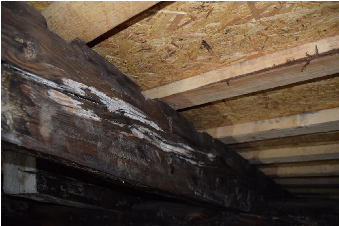
Foto 3. Seenkahjustusega (korgik) sarikas ruumi 3001 kohal. Proovi P1 võtukoht.
