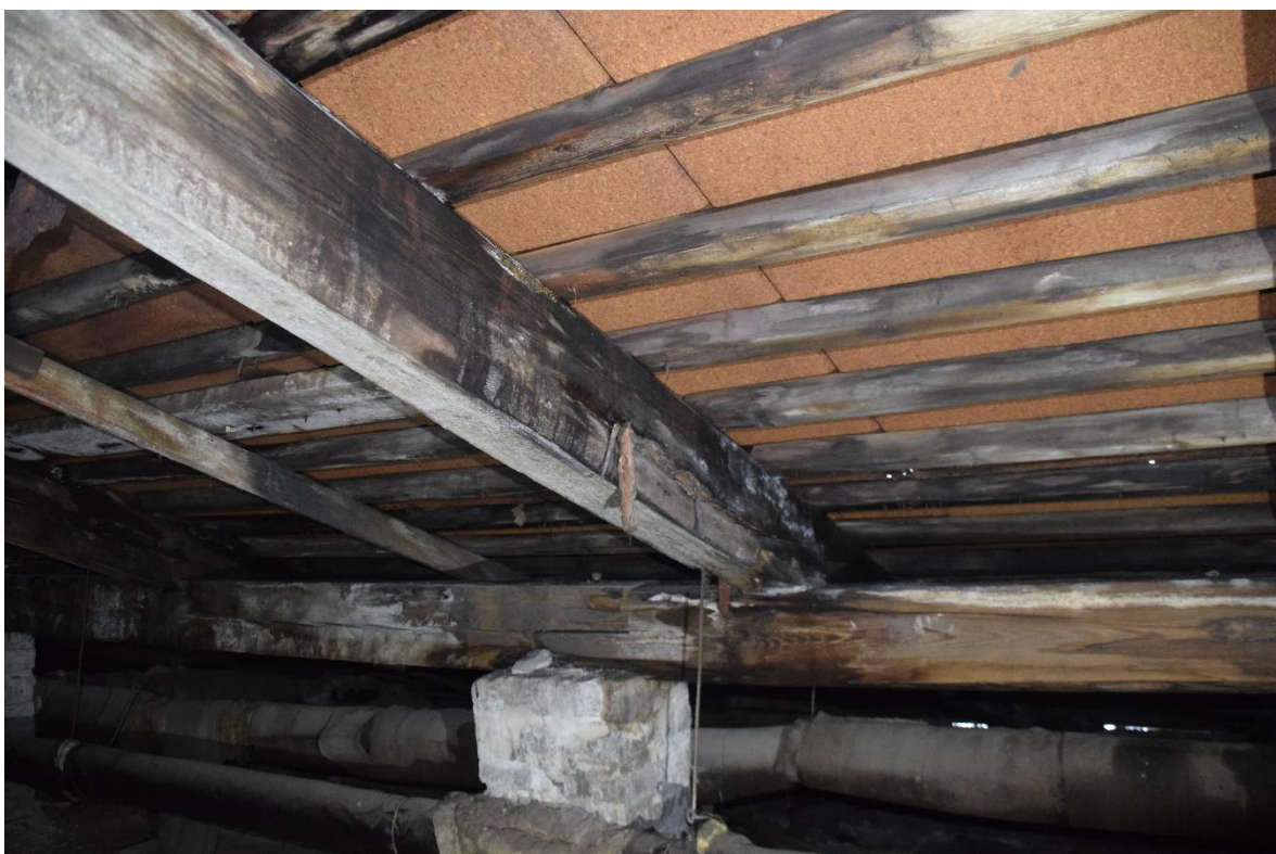
Foto 61. Kahjustatud sarikad ja toolvärgi vöö ruumi 3105 kohal.
