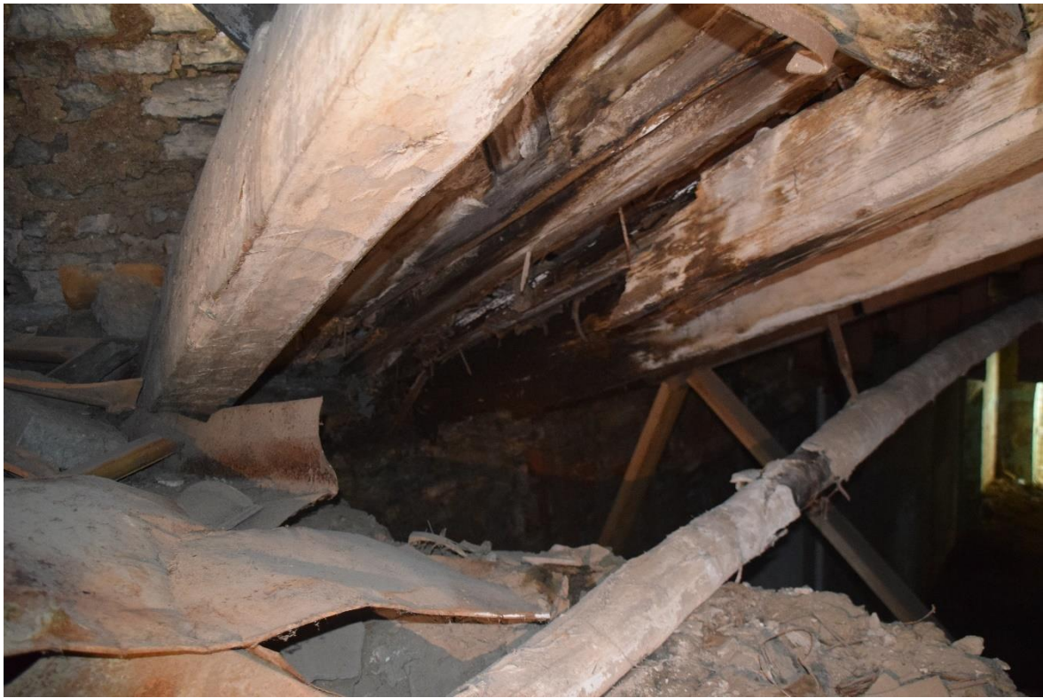
Foto 86. Kahjustatud ja purunenud sarikad Lüneti ja vahehoone ühenduskohas.
