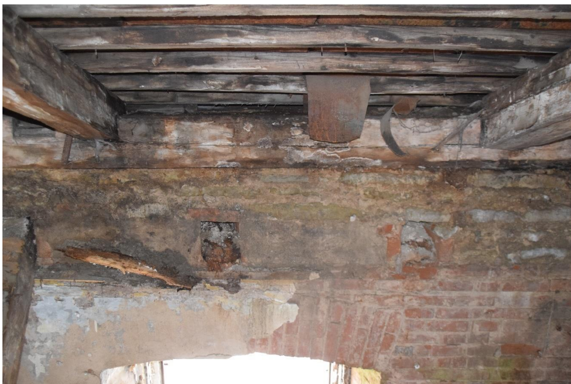
Foto 156. Kahjustatud müürlatt trepikoja akna kohal.
