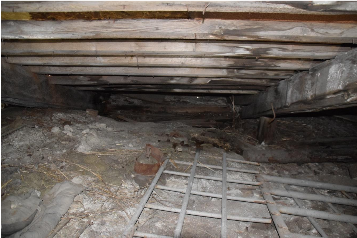
Foto 40. Kahjustatud sarikaotsad ruumi 3074 kohal.
