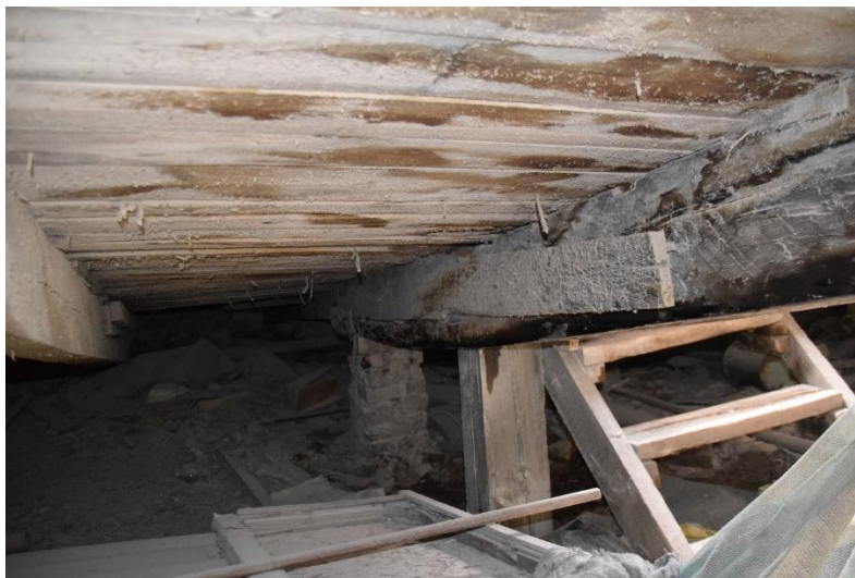
Joonis 7.3 Kahjustunud sarikas vintskapi kõrval ruumide 3019 ja 3020 kohal (autorifoto)
