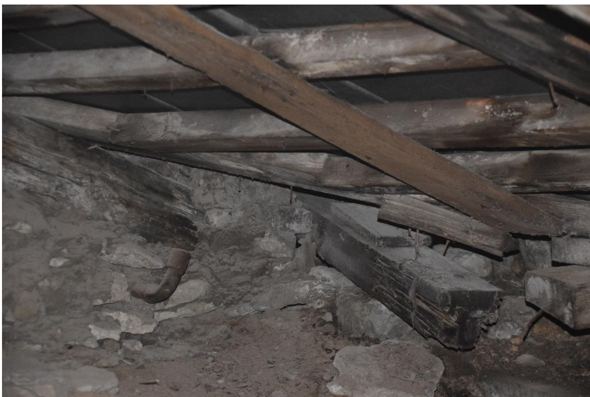
Foto 75. Kahjustatud sarikad ruumi 3021 kohal sisenurgas.
