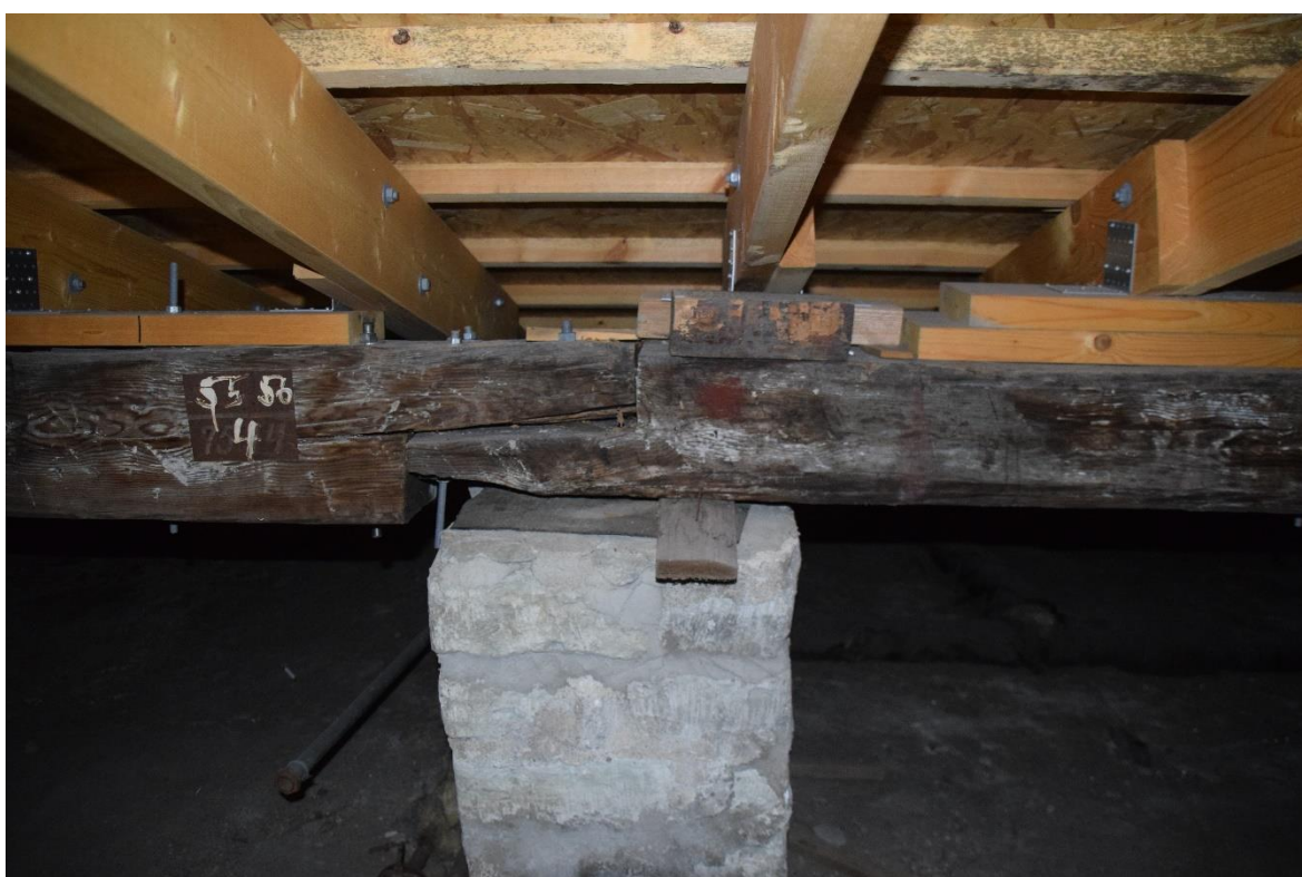
Foto 31. Nõrgestatud toolvärgi vöö ruumi 3054 kohal.
