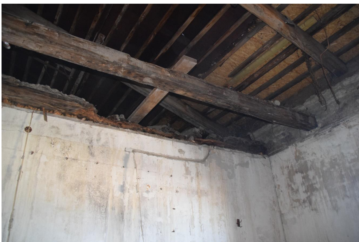
Foto 173. Tugeva kahjustusega vahelae talad ruumi 3185 kohal.
