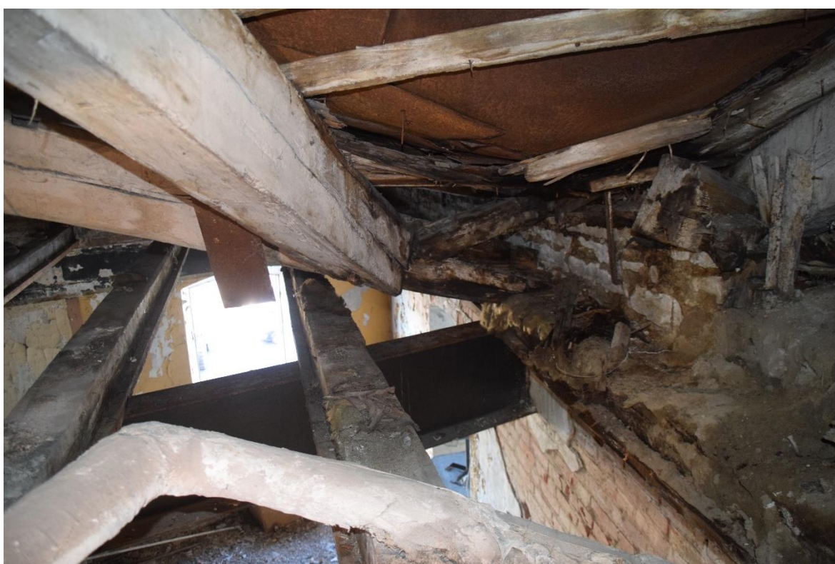
Foto 83. Kahjustatud neelukoha sarikad ruumi 3172 kohal.
