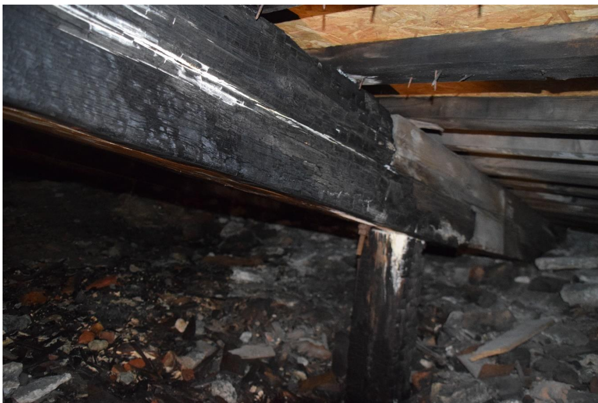
Foto 14. Seenkahjustusega sarikas ruumi 3005 kohal.
