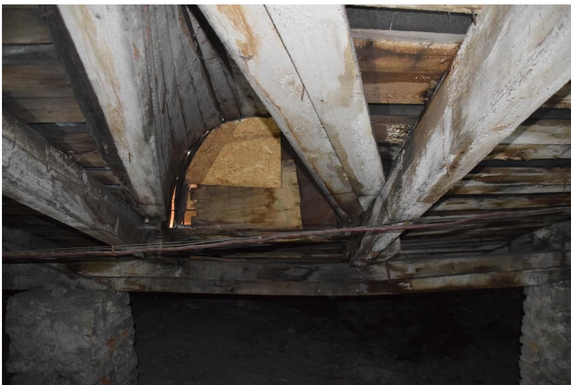
Foto 19. Kahjustatud sarikad ja toolvärgi vöö uugi all.
