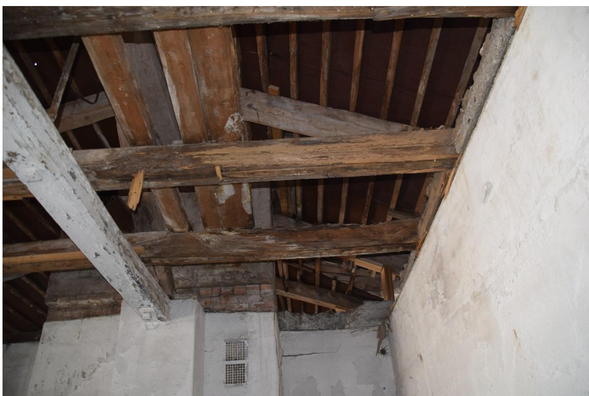
Foto 181. Kahjustatud talad ruumi 3197 kohal.
