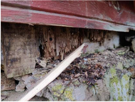
Foto 9. Keldri juures olev kahjustunud alumine puitlaudis (autori foto)
