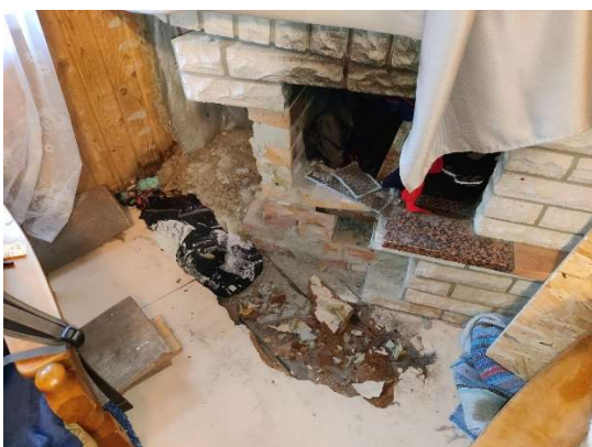
Foto 33. Ruumis 8 lagunenud kamin (autori foto)
