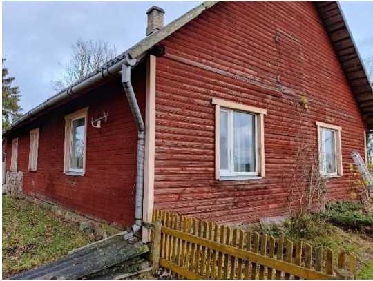
Foto 13. Üle värvimist vajav fassaadilaudis (autori foto)
