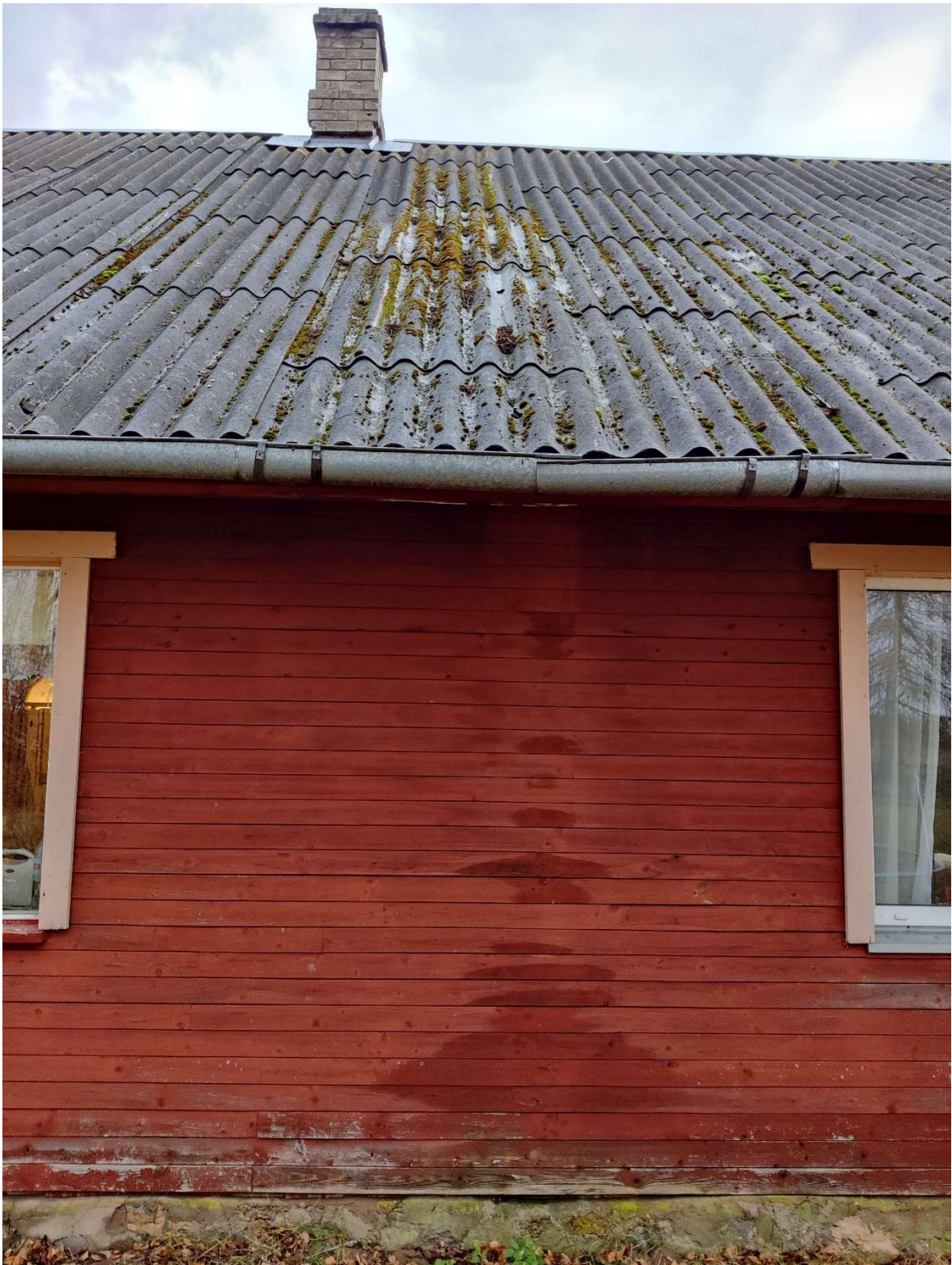
Foto 12. Hoone tagaküljel olev veekahjustus. Remonti vajav vihmaveerenn (autori foto)
