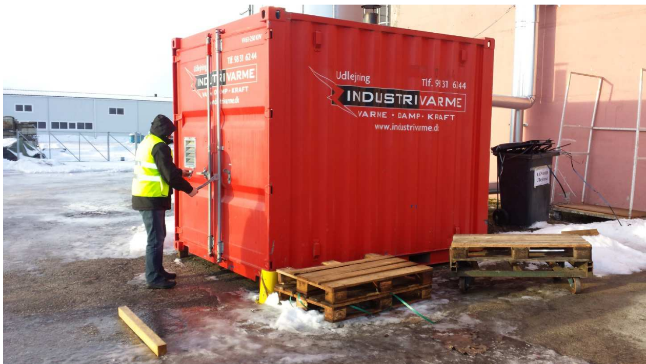
Sele 2.7 Kerge kütteõli konteinerkatlamaja. [5]
