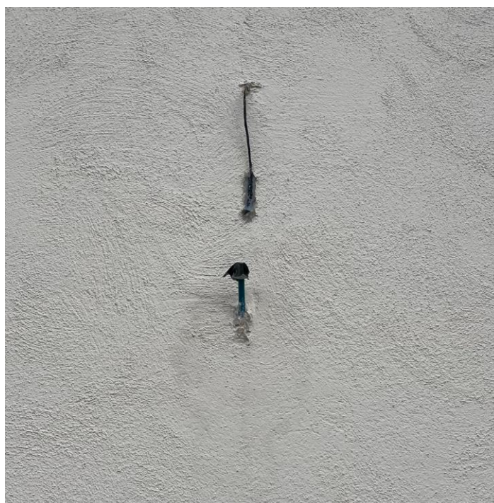
Joonis 65. Seinalõigul 44 sügisese katseperioodi lõpus veega küllastunud krohvikihit.
