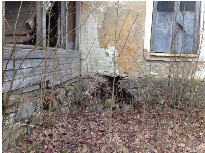
Joonis 2.5. Kahjustus hoone loodefassaadi sokliosas kohas, kus on vundamendis läbiviik kanalisatsiooni jaoks
