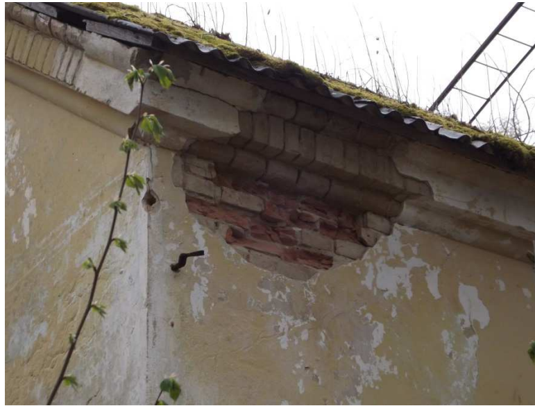
Joonis 2.1. Sein ja karniisi kahjustused loodefassaadil
