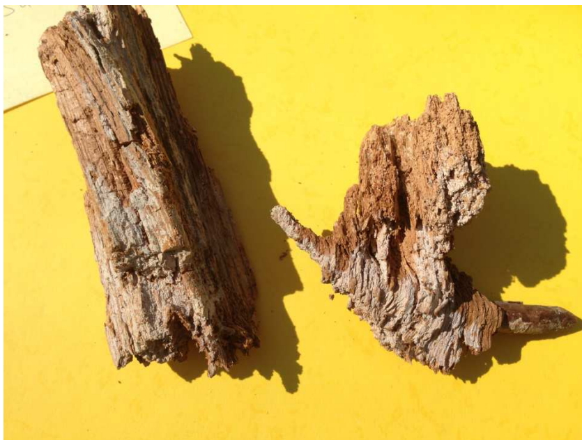
Joonis 4.2. Pehmemädanikuga kahjustunud proovitükid sarikast
