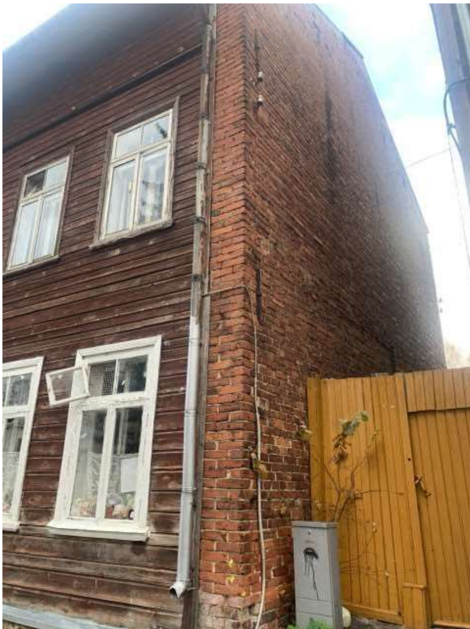
Foto 6. E. Enno tn 18 kortermaja tulemüür ning maja nurgas elektriliitumiskilp
