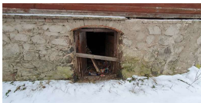
Joonis 15. Foto keldrisse pääsust, pildil näha sokli seisukorda
