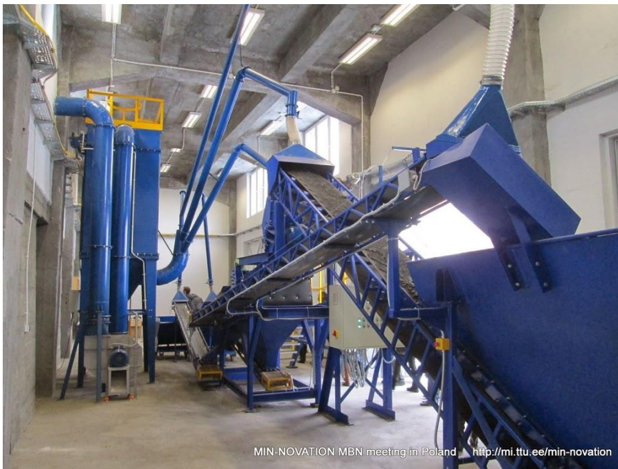
Joonis 15-5 Statsionaarne purustus ja sõelumissõlm
