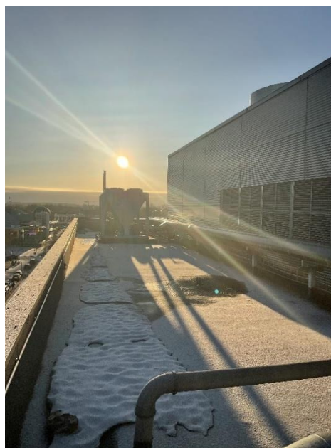
Joonis 12 Vaade külmaasinala
