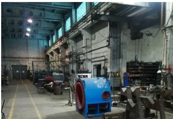
Joonis 1 Elektripaigaldiste ja seadistuse jaoskond
