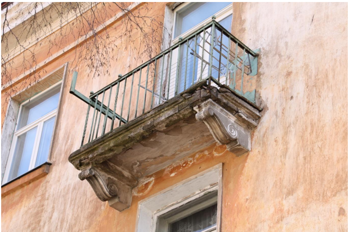
Joonis L1.16 Tugevate niiskuskahjustustega rõdu hoone läänepoolses otsas
