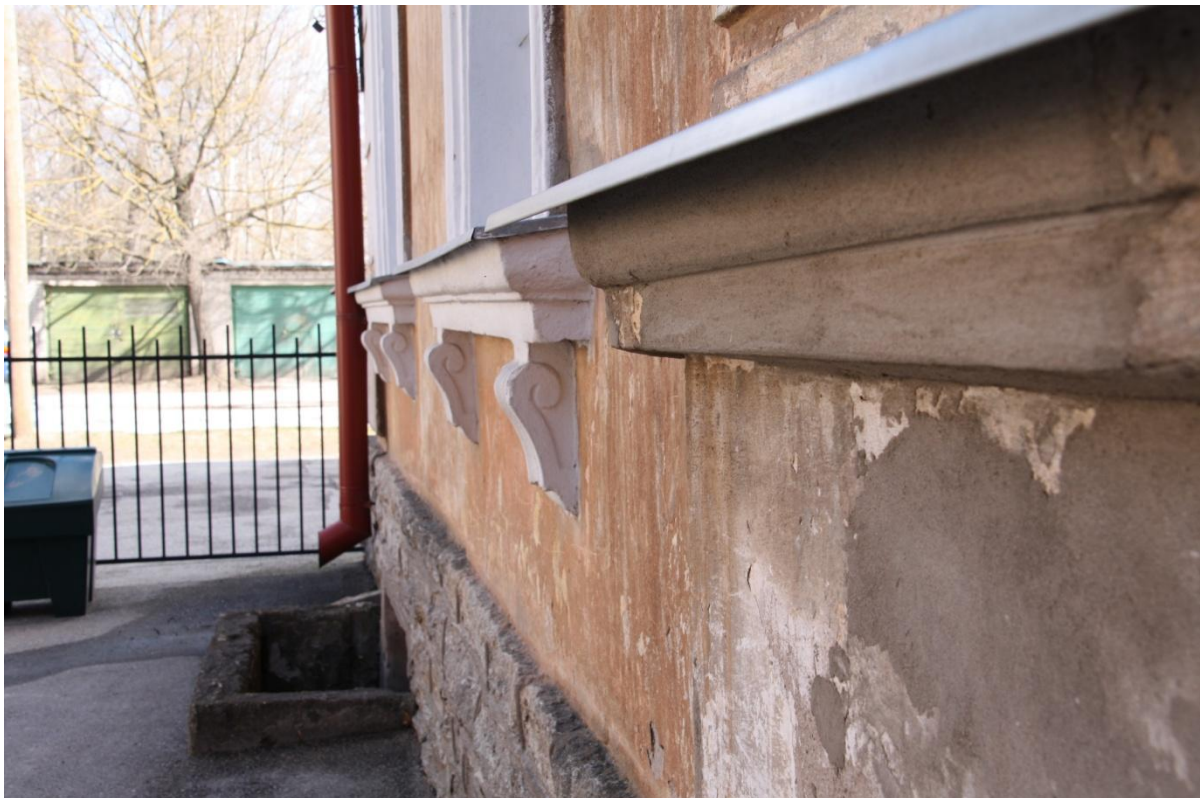
Joonis L1.18 Vale profiiliga ning tsementkrohviga remonditud karniis
