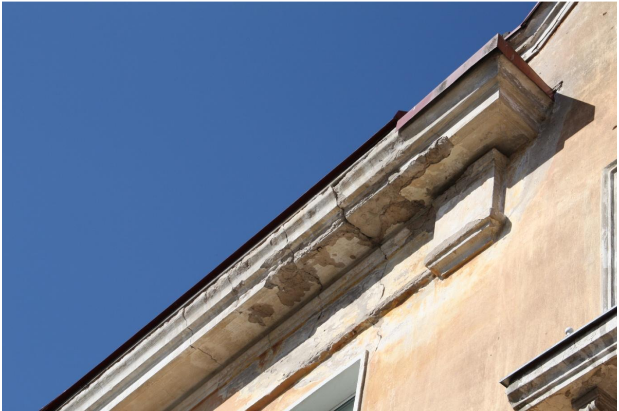
Joonis L1.17 Räästakarniisi kahjustused kolmnurkviilu servas
