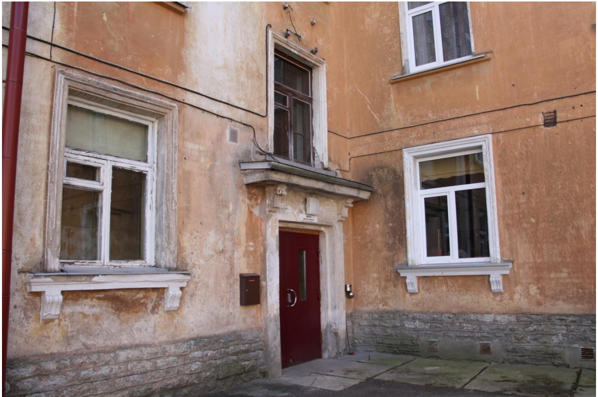
Joonis L1.12 Trepikoja sissepääs. Vasakpoolne ning trepikoja aken ilmselt ehitusaegne, paremal näha vale ruudujaotusega PVC-aken
