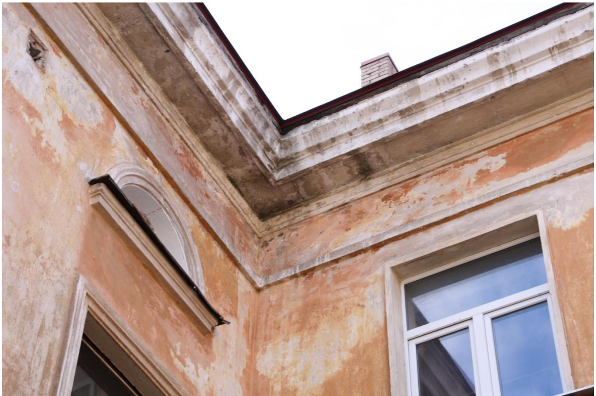
Joonis L1.13 Trepikoja poolkaaraken. Räästakarniis ja fassaadikrohv on saanud niiskuskahjustusi
