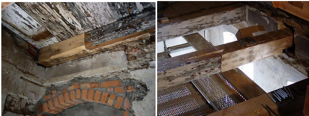
Joonis 4.1-2 Bioloogilised kahjustused
