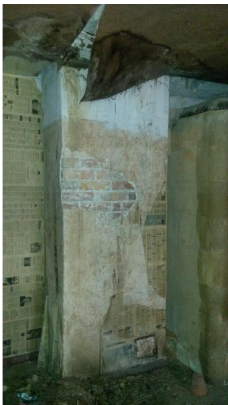
Foto 80. Ruumi 18 lae niiskuskahjustus. (Foto: autor, mai 2014)
