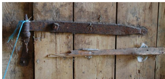
Foto 67. Latriukse SU27 vasakpoolne alumine uksehing DS21. (Foto: autor, mai 2014)
