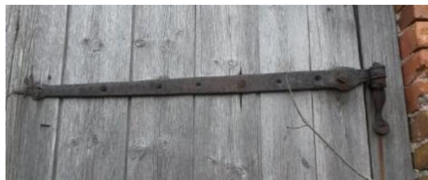
Foto 41. Tagafassaadi ukse VU3 sepiostatud ülemine hing DV11. (Foto: autor, mai 2014)
