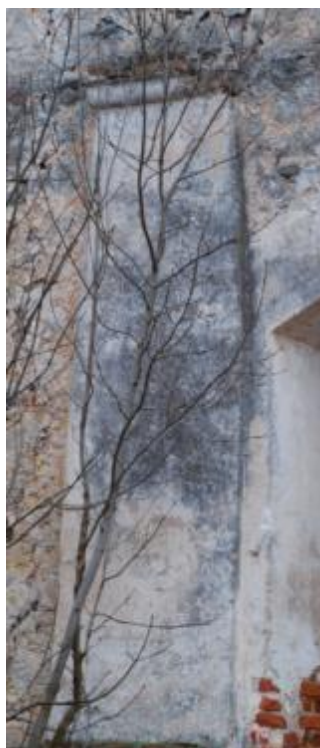
Foto 30. Lõunapoolse otsaseina vasakpoolne pilaster. (Foto: autor, mai 2014)
