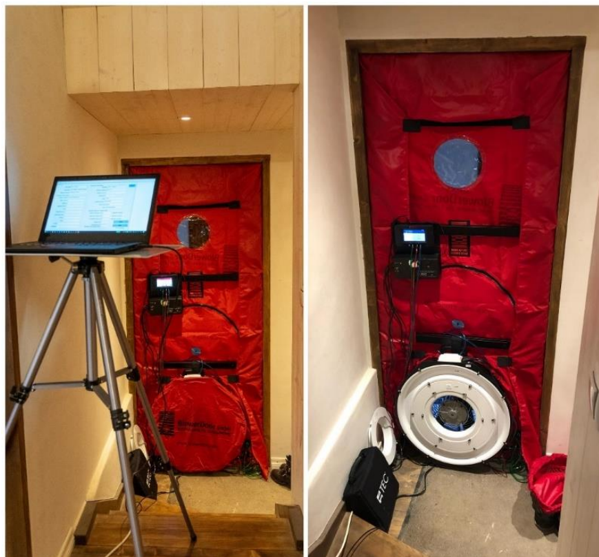
Joonis 3.5. Õhulekkestesti läbiviimine ventilaatoriga survestamise meetodil
