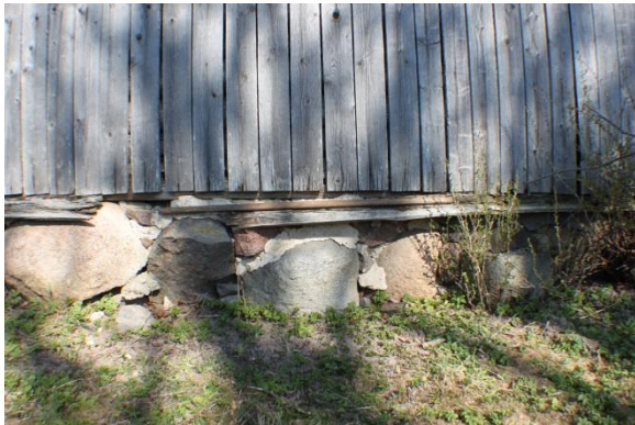
Foto nr 9. Läbi vajunud vundament ja pehkinud veelaud
