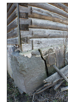
VUNDAMENDI NURGAKIVI ON VAJUNUD VÄLJA STABILISEERIDA VUNDAMENT
