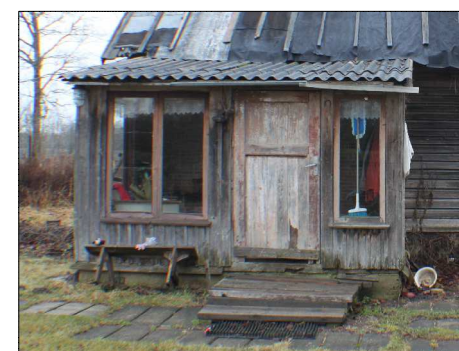
ESIKU AKNAD JA UKS EI OLE ALGUPÄRASED, TREPP ON AMORTISEERUNUD, EHITADA UUS, HOONEGA SOBIV, ESIK
