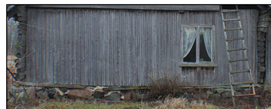
VUNDAMENT ON KESKELT LÄBI VAJUNUD VUNDAMENT TULEB UUESTI LADUDA JA ALUMISED PALGIREAD ASENDADA
