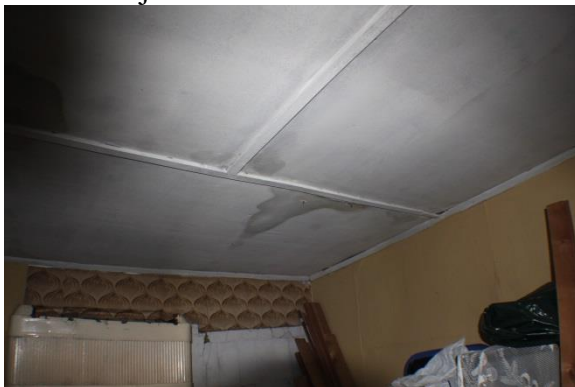
Foto nr 33. Lagedes on niiskuskahjustused
