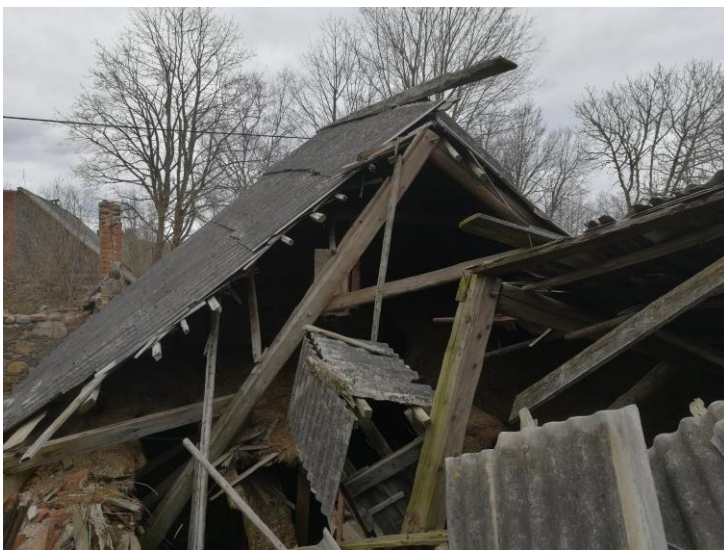
Foto 7. Põhjatiiva avariiline katus (Foto: autor, aprill 2017)
