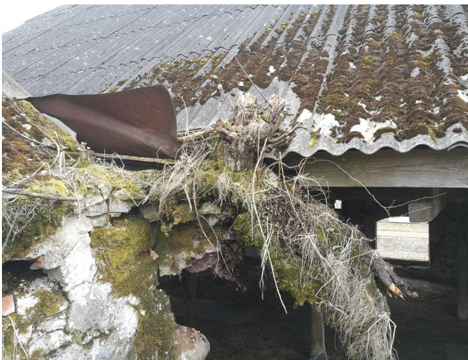
Foto 3. Lõuna- ja põhjatiiva nurgas olevad juured ja samlikud. (Foto: autor, aprill 2017)
