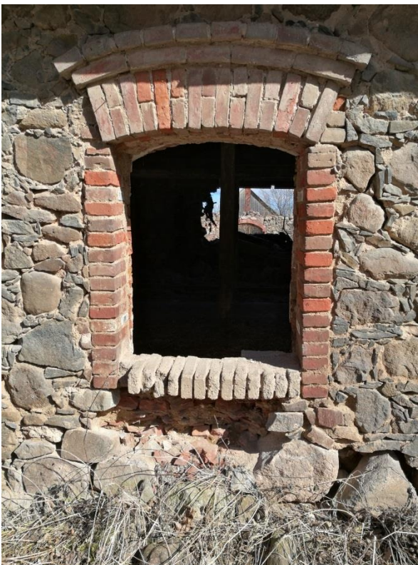
Foto 9. Puuduliku äärisega aken (Foto: autor: aprill 2017)
