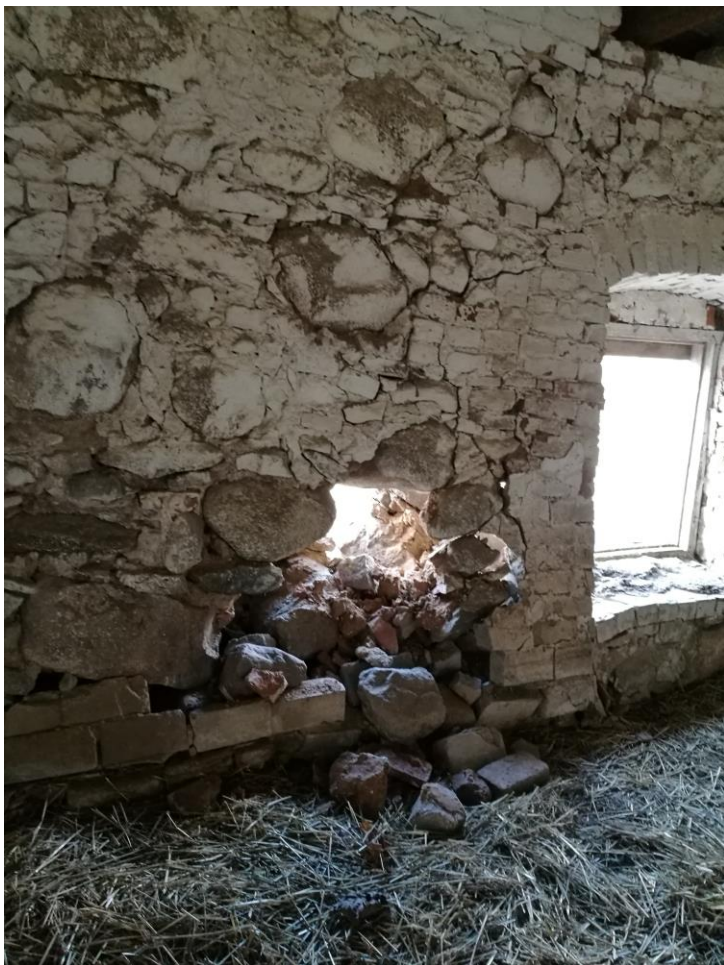
Foto 4. Kirdekülje avariiline müüritis (Foto: autor, aprill 2017)
