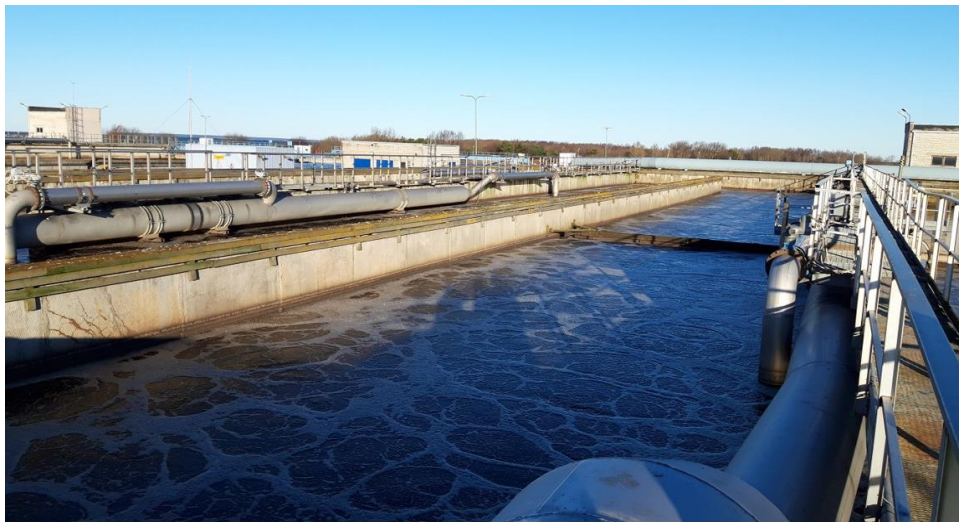
JOONIS 12-1 Reoveepuhastusjaama aerotank, Tallinn. (Foto: Janek Laanearu, 2020)
