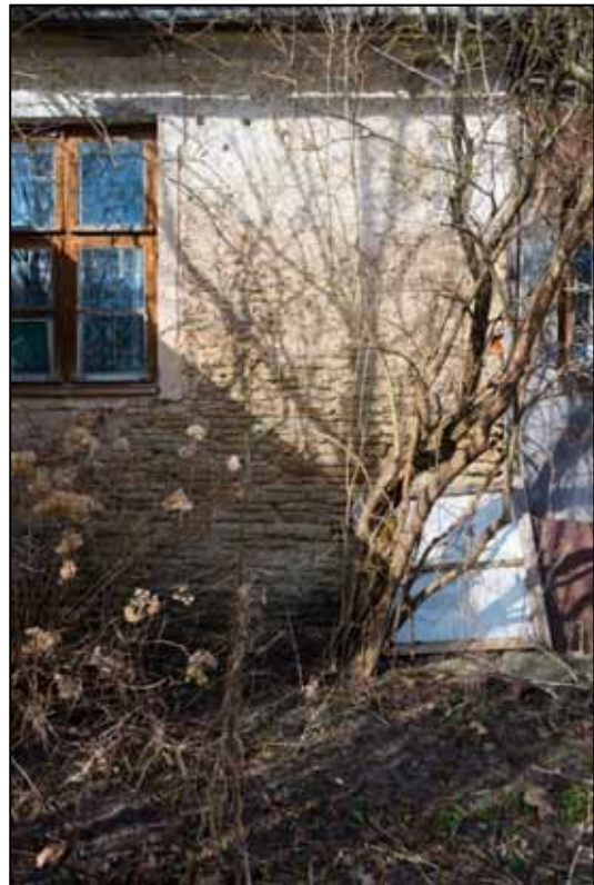
Foto 51. Lõunapoolse fassaadi lagunenud krohv. (Foto: autor, aprill 2015).
