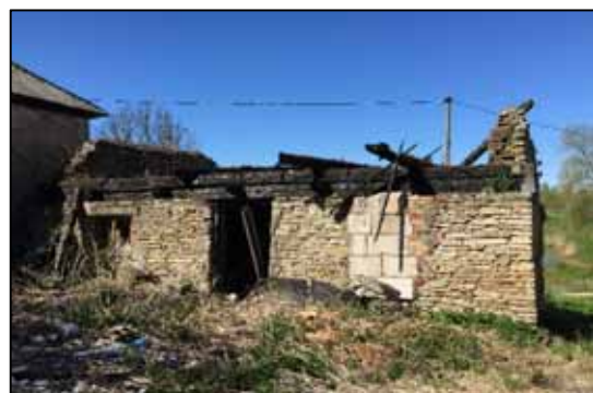
Foto 59. Abihoone taga paiknev põlenud hoone. (Foto: autor, aprill 2015)
