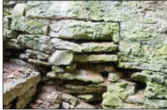
Foto 41. Lagunenud soklikivid keldritrepi kõrval asuvas sokliosas. (Foto: autor, aprill 2015)
