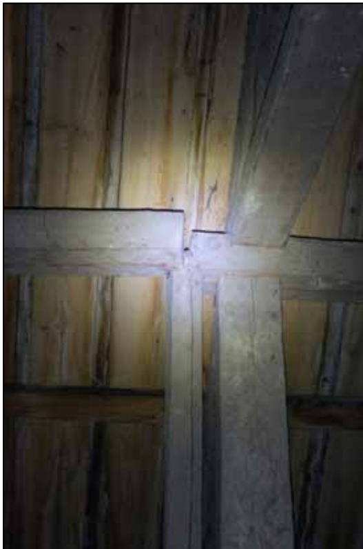
Foto 50. Deformeerunud katusekonstruktsioonide sõlm (Foto: autor, aprill 2015).
