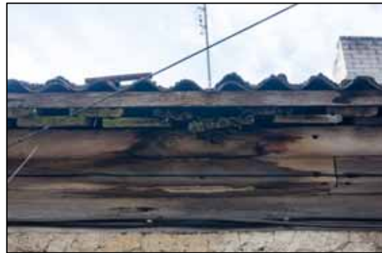
Foto 43. Pehkinud laudkatus ning niiskuskahjustused karniisil hoone põhjapoolsel fassaadil. (Foto: autor, aprill, 2015)
