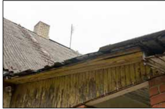
Foto 53. Lõunapoolse veranda lagunenu katusekate ja laudis. (Foto: autor, aprill 2015)
