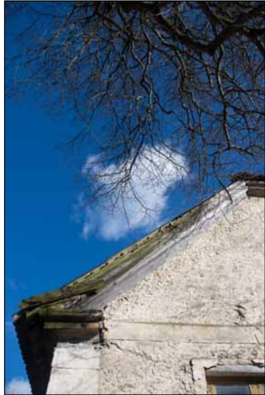
Foto 49. Pehkinud puitkarniis hoone läänefassaadil. (Foto: autor, aprill 2015).
