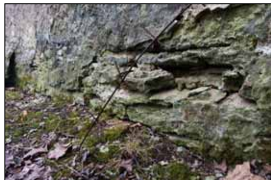
Foto 47. Kahjustused soklis hoone põhjafassaadil. (Foto: autor, aprill 2015)
