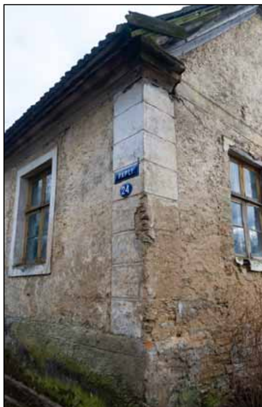
Foto 11. Nurgaliseen hoone loodenurgas. Nähtavad kahjustused ning paljastunud seinakonstruktsioonid (Foto: autor, aprill 2015)
