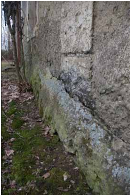
Foto 36. Põhjapoolse fassaadi sokli niiskuskahjustused akna A02 all. (Foto: autor, märts 2015)
