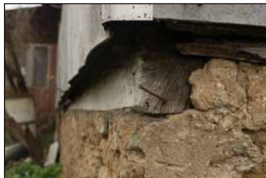
Foto 46. Pehkinud alumised palgid puidust hooneosas. (Foto: autor, aprill 2015)
