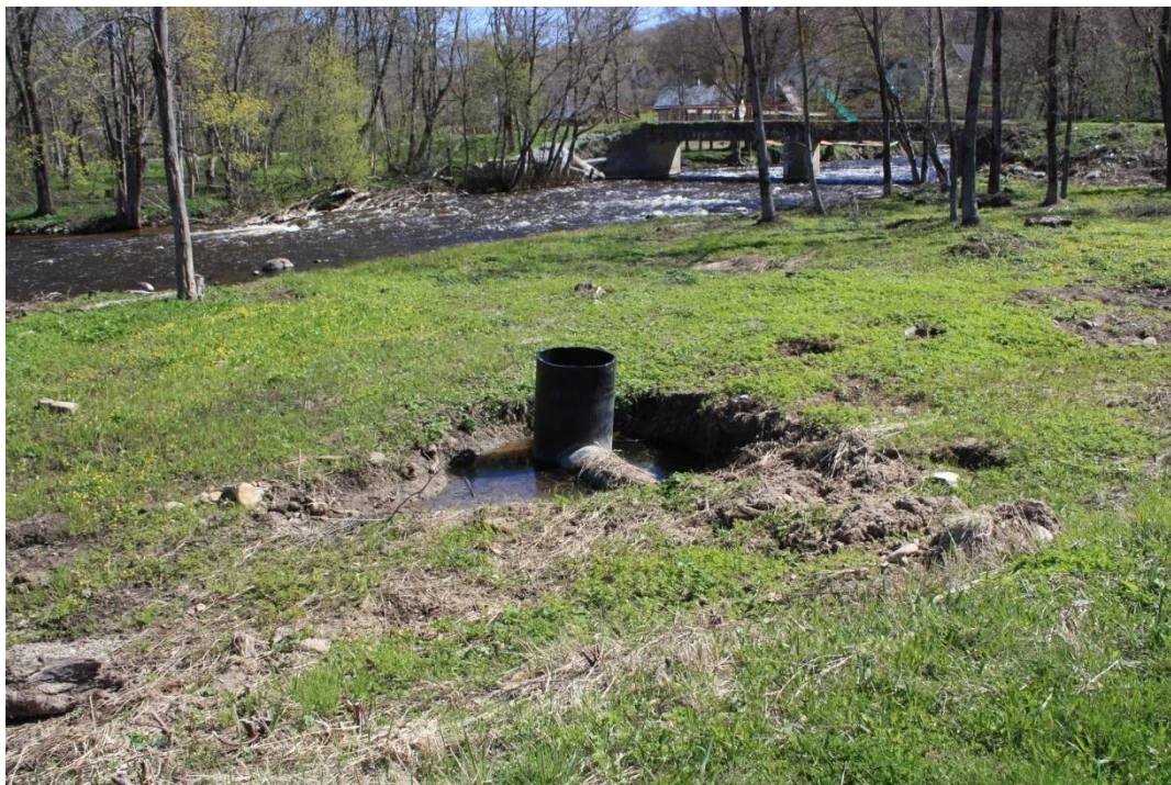
Joonis 27-2 Sild kohviku juures piirab oluliselt veevoolu jões. Vesi on madal ja voolab mööda sängipõhja. Kui veehulk suureneb, peab veetase tõusma, sest sängi laiust on vähendatud
