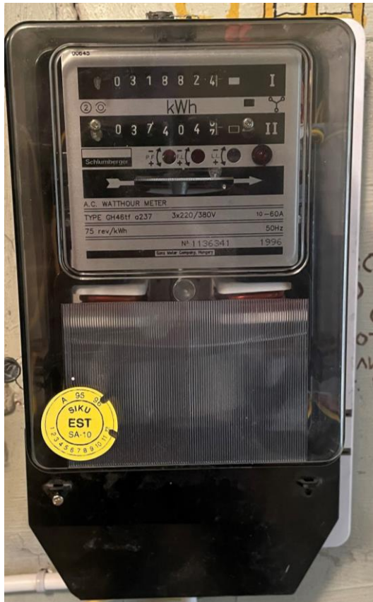
Joonis 3.1 Masinaruumis paigaldatud elektriavesti
