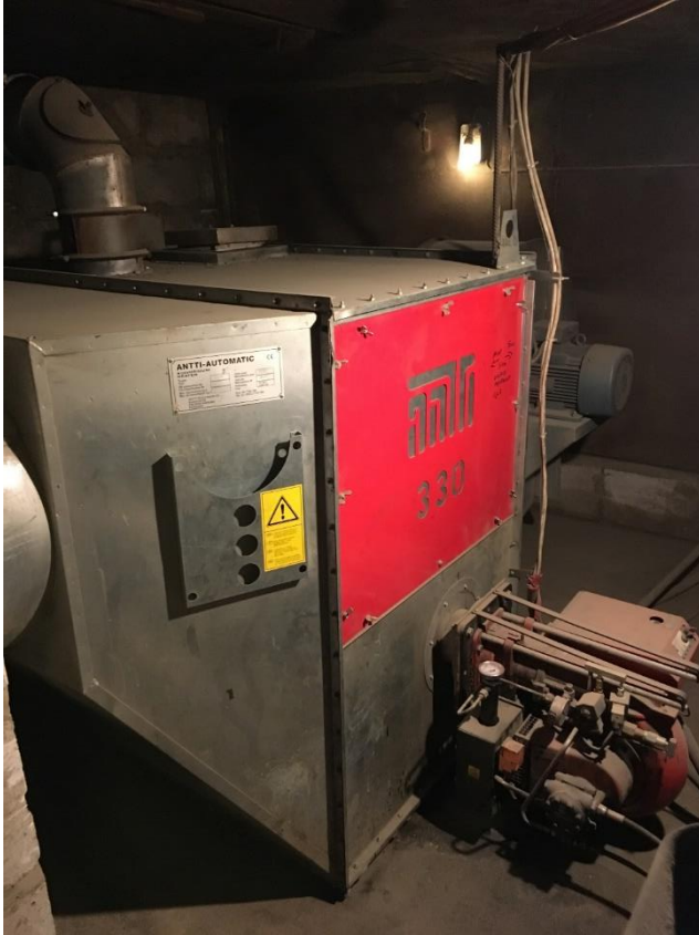
Joonis 1.7 Väikse kuivati katel võimsusega 330 kW
