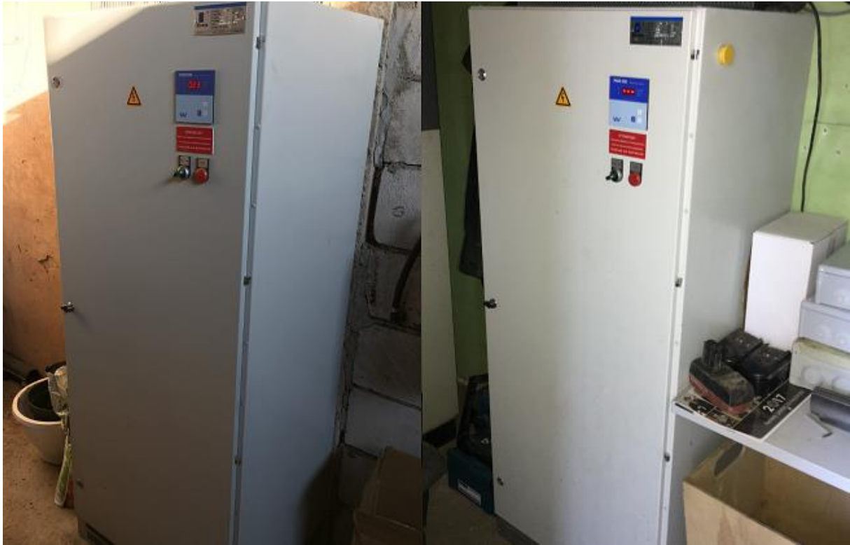
Joonis 1.10 Reaktiivenergia kompensaatorseadmed RKS1 ja RKS2. (Vasakul vana kuivati ja parema uue kuivati seade)
