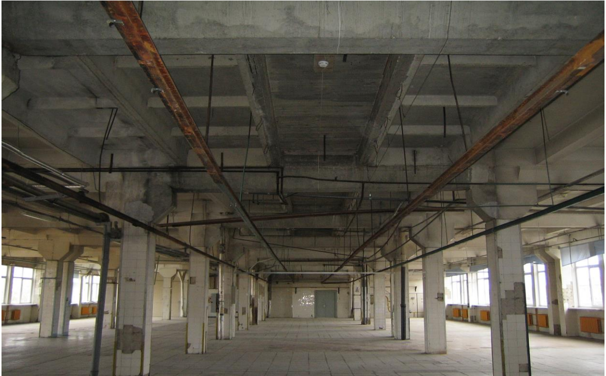
Joonis 10. Hoone 3. korruse seisukord enne arendust.
