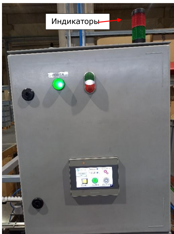
Рисунок 48. Электрический щит управления и индикаторы
