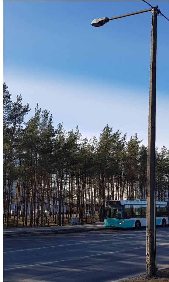
Joonis 1.5. Amortiseerunud raudbetoonmast
