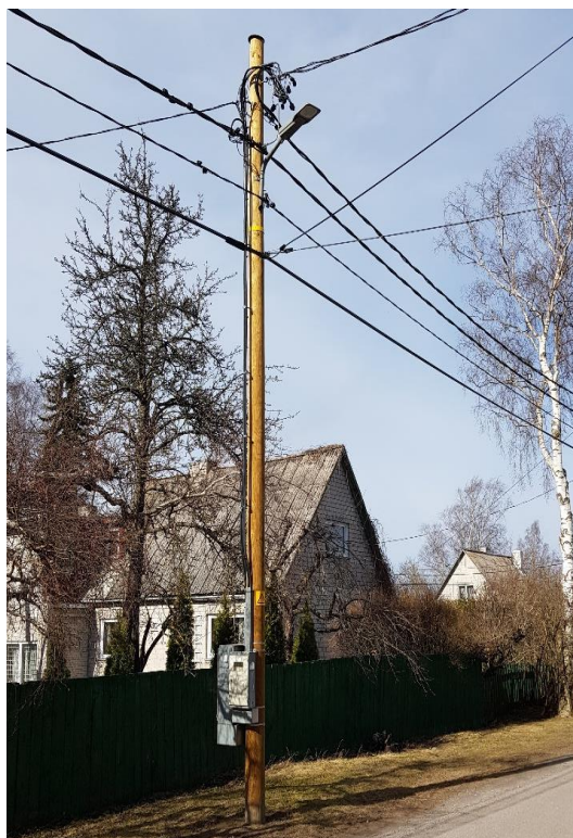
Joonis 1.2 Elektrilevi mast, millele on paigaldatud ka valgusti
