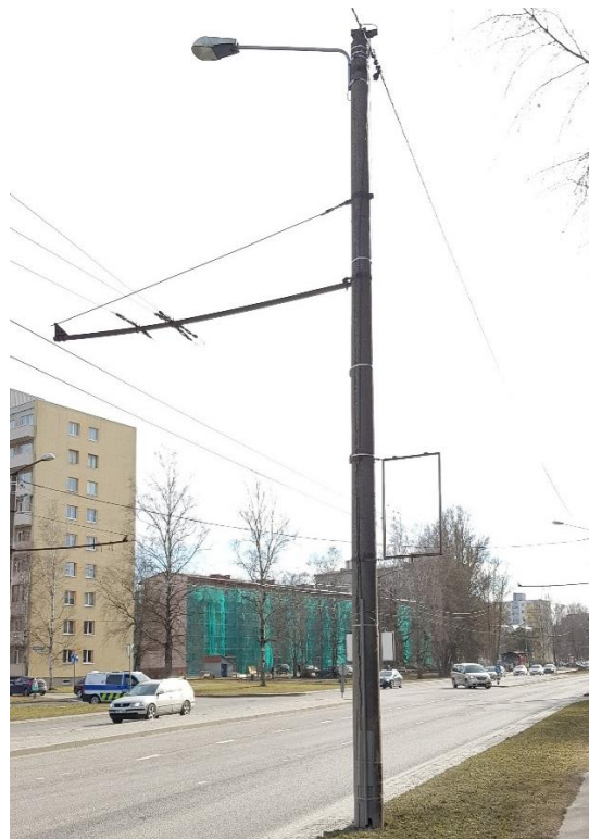
Joonis 1.3. Tallinna Transpordiameti mast, millele on paigaldatud ka valgusti
