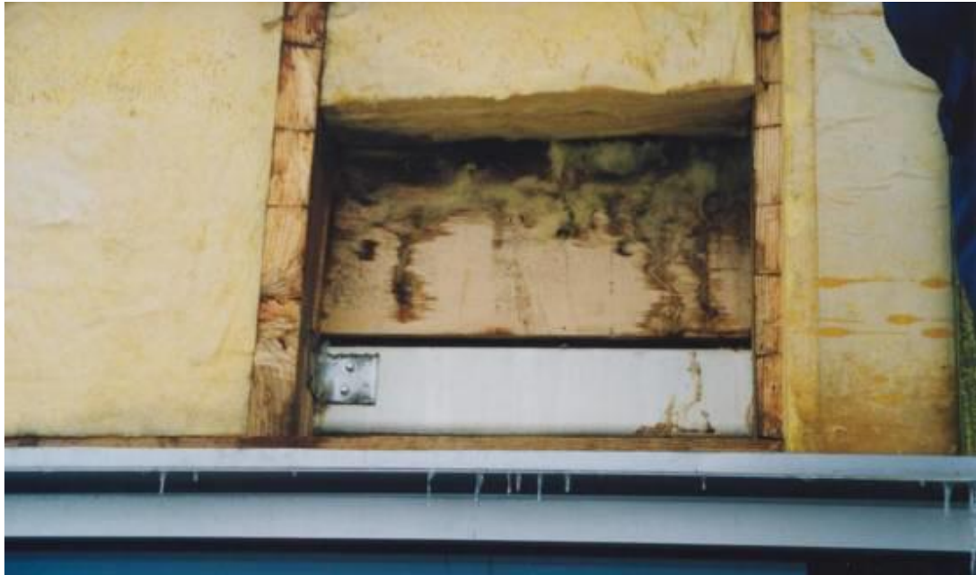
Joonis 1.7 Jääpurikad ja niiskuskahjustused vineeri ja puidu pinnal [2]
