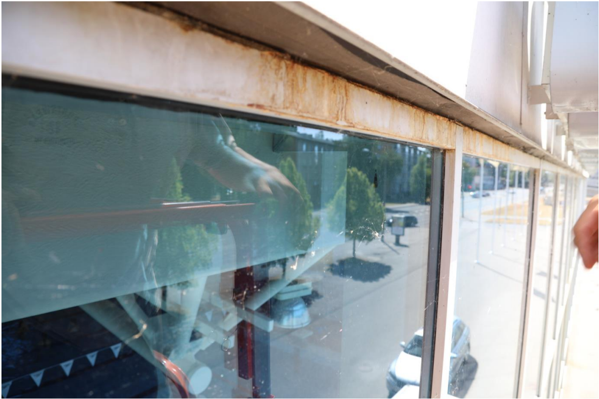
Joonis 1.10 Läbijooksujäljed Turu tn poolsel fassaadil [1]
