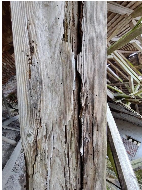
Joonis 2.19 Putukkahjustusega konstruktsioon (Foto: autor, aprill 2021)
