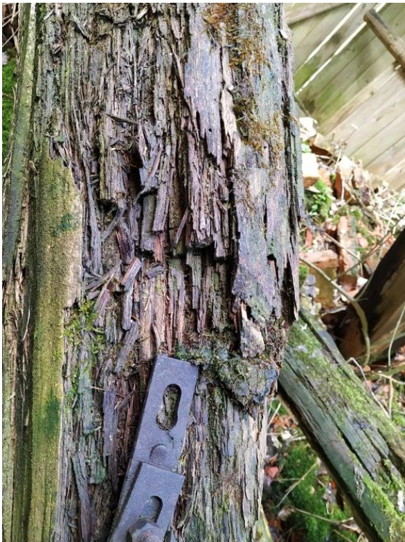
Joonis 2.18 Mädanikkahjustusega tala (Foto: autor, aprill 2021)
