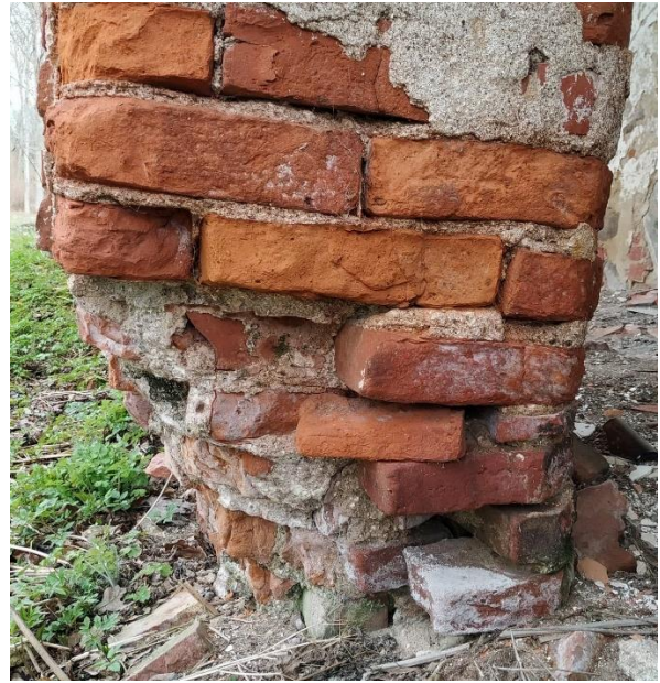
Joonis 2.9 Külmakahjustuste tõttu lagunenu kaaristu sammas (Foto: autor, november 2020)
