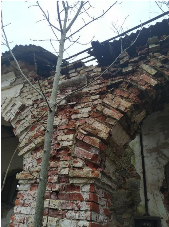
Joonis 2.8 Avariiline räästakarniis ja kaaristu (Foto: autor, november 2020)
