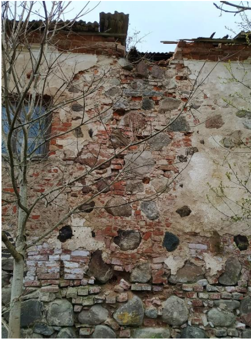
Joonis 2.6 Idafassaadi tugevalt kahjustunud välissein (Foto: autor, november 2020)
