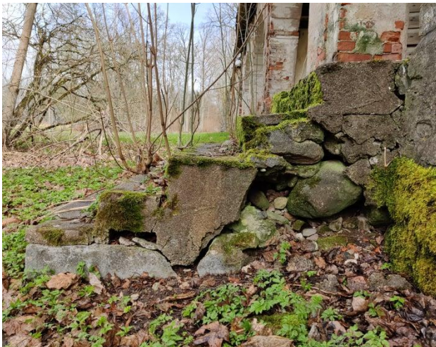
Joonis 2.27 Lagunenud betoontrepp hoone ees (Foto: autor, aprill 2021)
