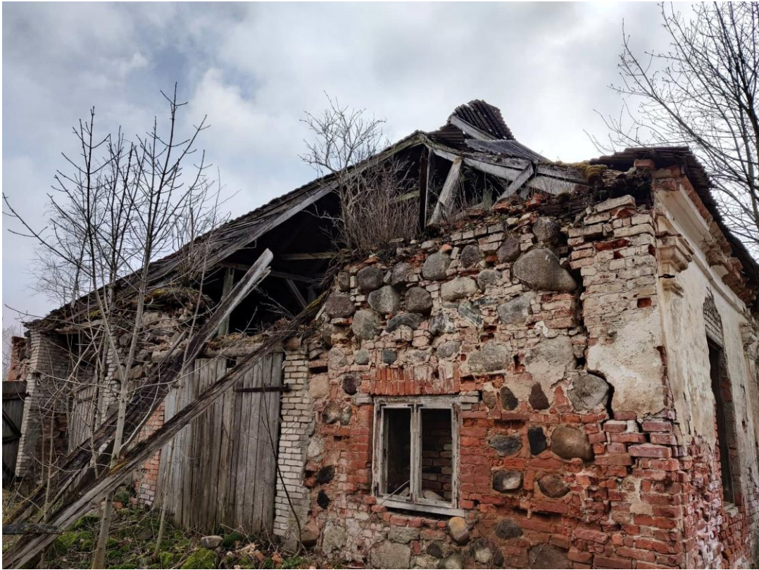
Joonis 2.10 Avariilises seisukorras põhjapoolne osa (Foto: autor, november 2020)
