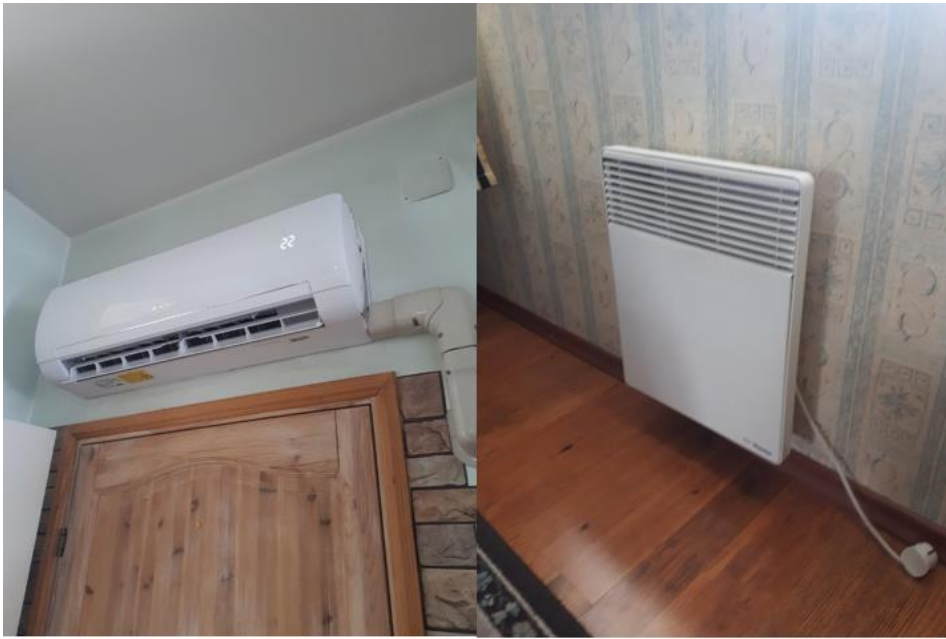
Joonis 21 Eramu esimesel korrusel paiknevad lisa (elekter) kütteseadmed (Torim, 2021)
