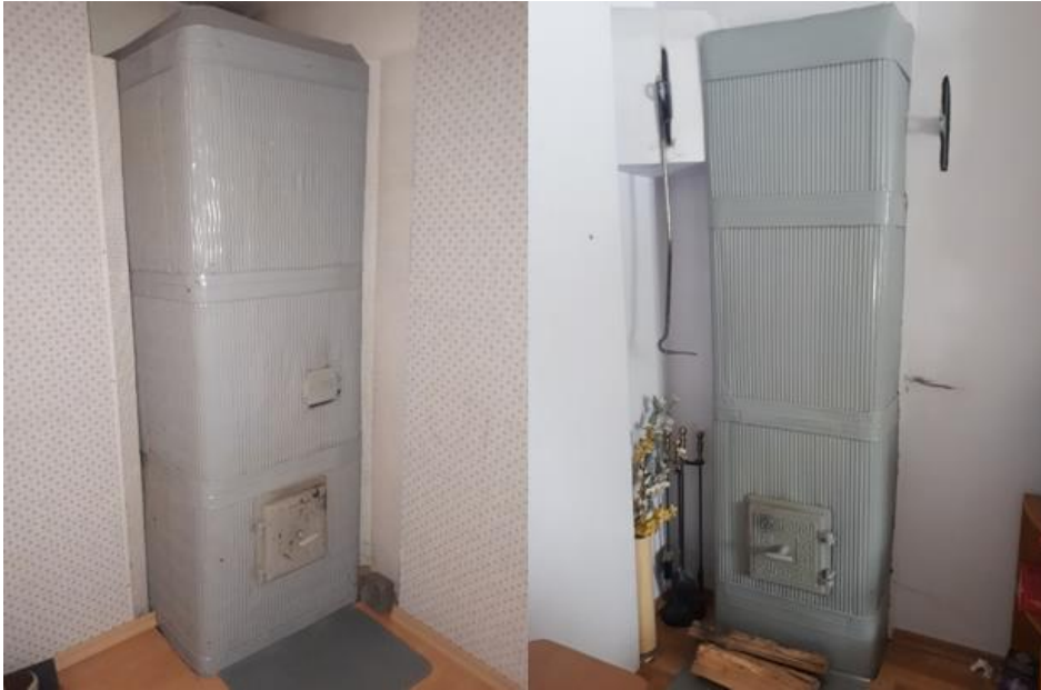
Joonis 19 Eramu teisel korrusel paiknevad kütteseadmed (Torim, 2021)
