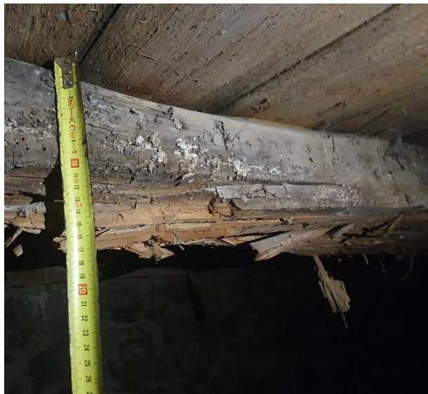
Joonis 3.4 Pehkinud põrandatala keldri kohal (autori foto, märts 2022)
