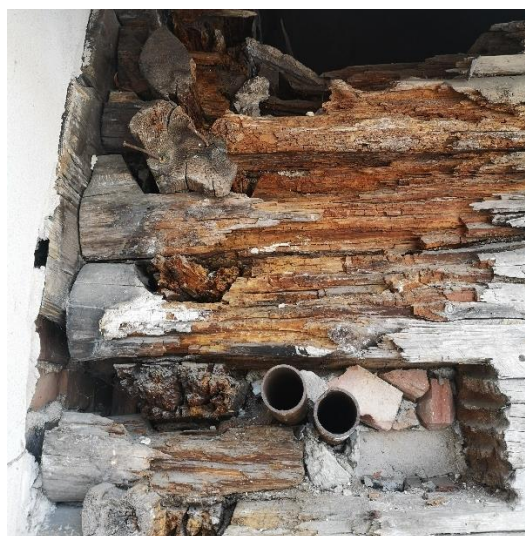
Joonis 3.9 Räästaalused palgikahjustused (autori foto, märts 2022)
