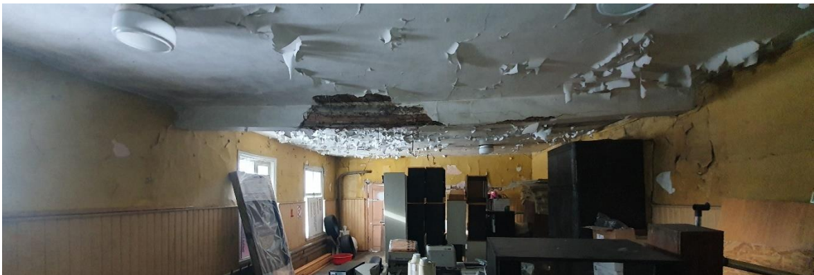
Joonis 3.12 Läbi paindunud tala risti hoonet (autori foto, märts 2022)
