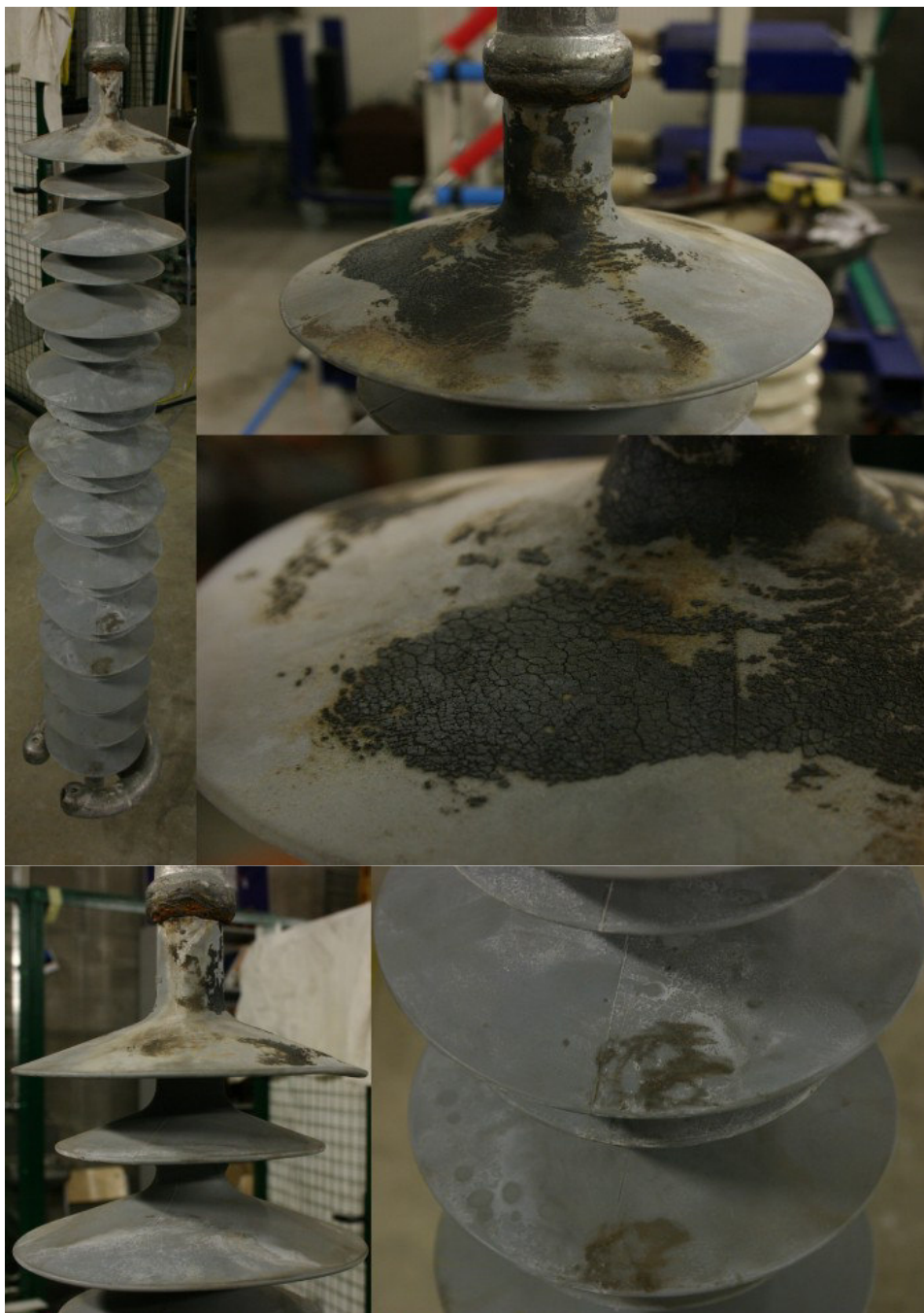
Joonis 5.3 Seelikupinna saastumine, osa- ja kaarlahenduste kahjustused (heledad ja tumedad laigud). Armeeringu erosioon.
