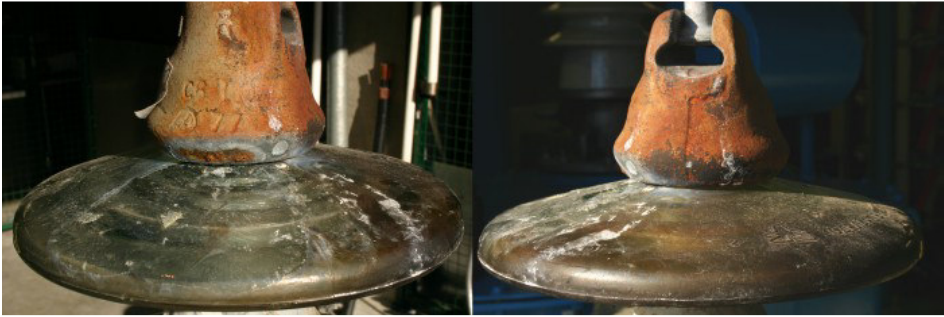
Joonis 5.14 Ekskrementide ja traaversi (kinnitusdetailide) korrosiooni saastejäljed ülemisel isolaatoril. Ekskrementide põhjustatud erosioon isolaatori mütsil.
