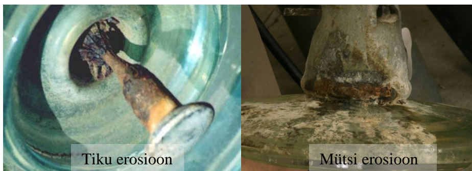
Joonis 2.3 Klaasist taldrikisolaatori tiku [2] ja mütsi erosioon.
