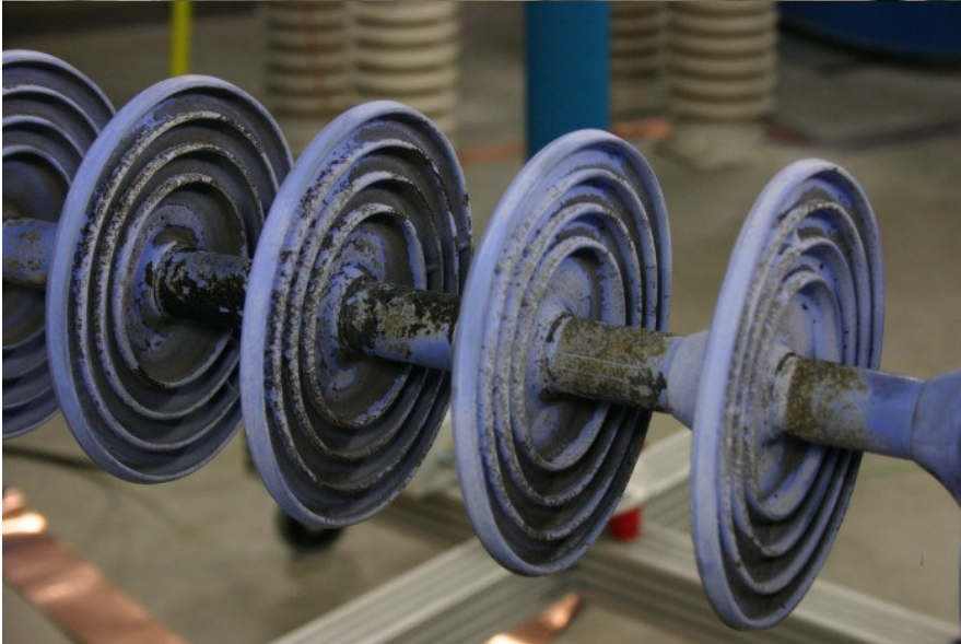
Joonis 5.9 Seelikupinna saastumine, kaarekahjustused.
