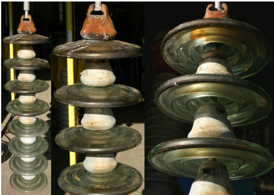
Joonis 5.13 Ekskrementide ja traaversi korrosiooni saastejäljed ülemistel isolaatoritel.
