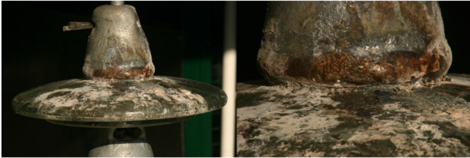
Joonis 5.16 Ekskrementide jäljed ülemisel isolaatoril. Ekskrementide põhjustatud erosioon ülemise isolaatori mütsil.
