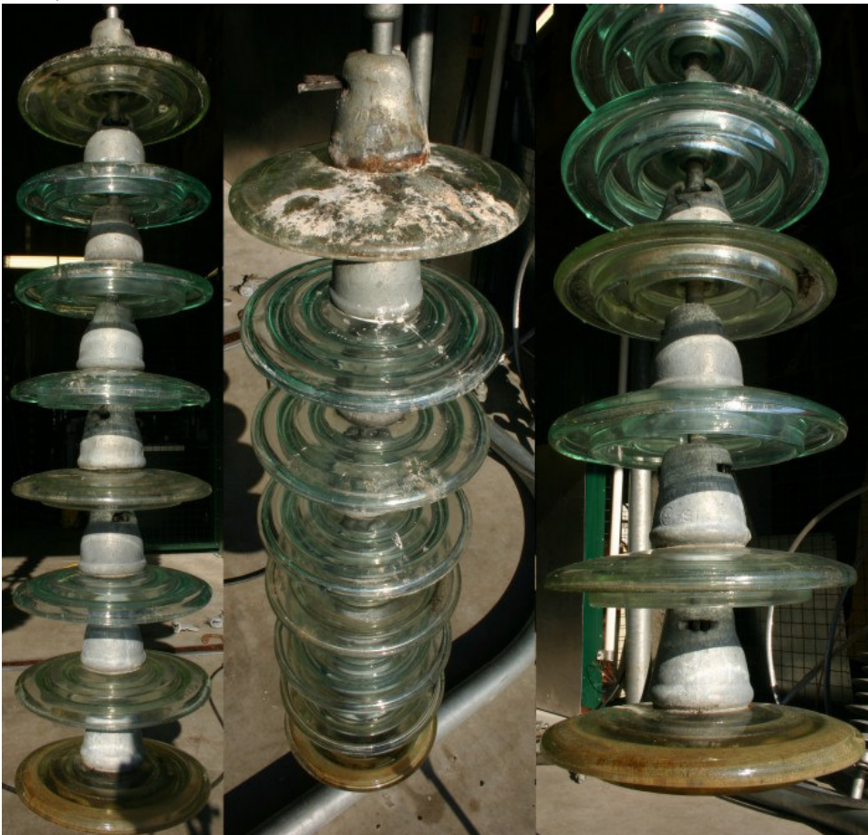
Joonis 5.15 Ekskrementide jäljed ülemistel isolaatoritel. Ekskrementide põhjustatud erosioon ülemise isolaatori mütsil. Faasijuhi kinnitusdetailide korrosioonisaaste jäljed alumisel isolaatoril.
