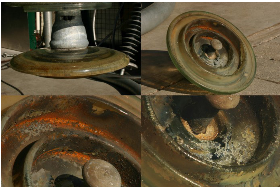
Joonis 5.17 Faasijuhi kinnitusdetailide või metallse tolmsaaste korrosioonijäljed alumisel isolaatoril.
