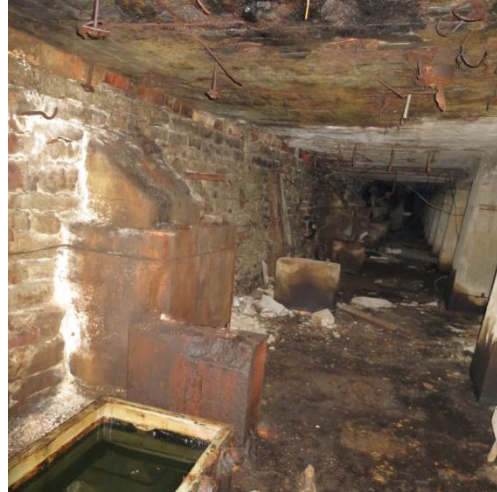
Foto 17. Kolmanda seisunditaseme vundament - tugev õlikahjustus
