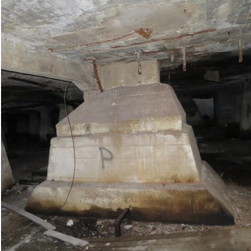
Foto 16. Kolmanda seisunditaseme vundament - õlikahjustus vundamendi allosas
