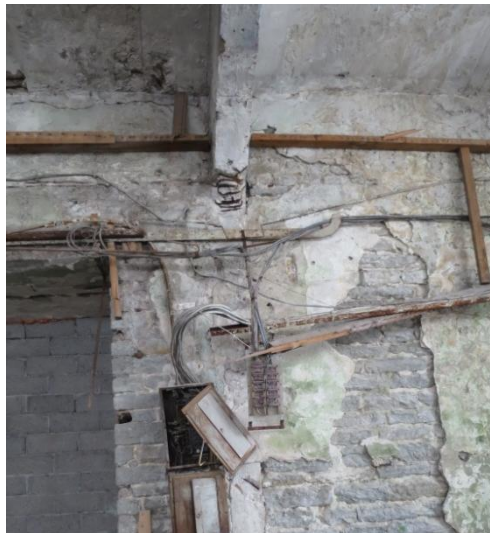
Foto 35. Osaliselt kolmanda seisukorra post-sarrus posti ülaosas korrodeerunud RP01
