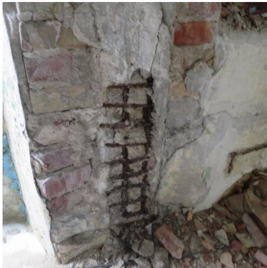
Foto 34. Osaliselt kolmanda seisukorra post RP18
