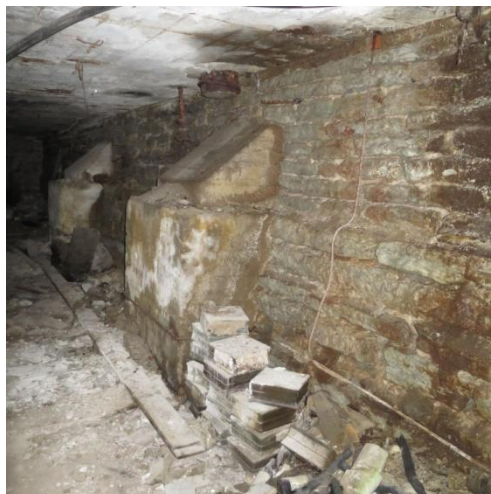
Foto 15. Teise seisunditaseme vundament - sool- ja niiskuskahjustused
