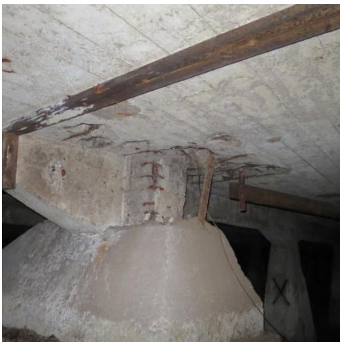
Foto 14. Teise seisunditaseme vundament - korrodeerunud sarrus
